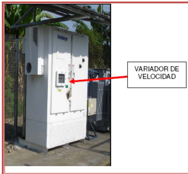
FIGURA 5. VARIADOR DE FRECUENCIA.
