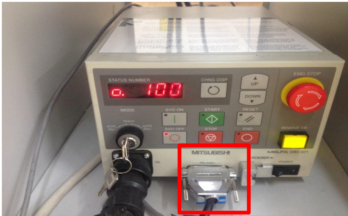
Figura 5.3. Puerto de comunicación de la unidad controladora.
