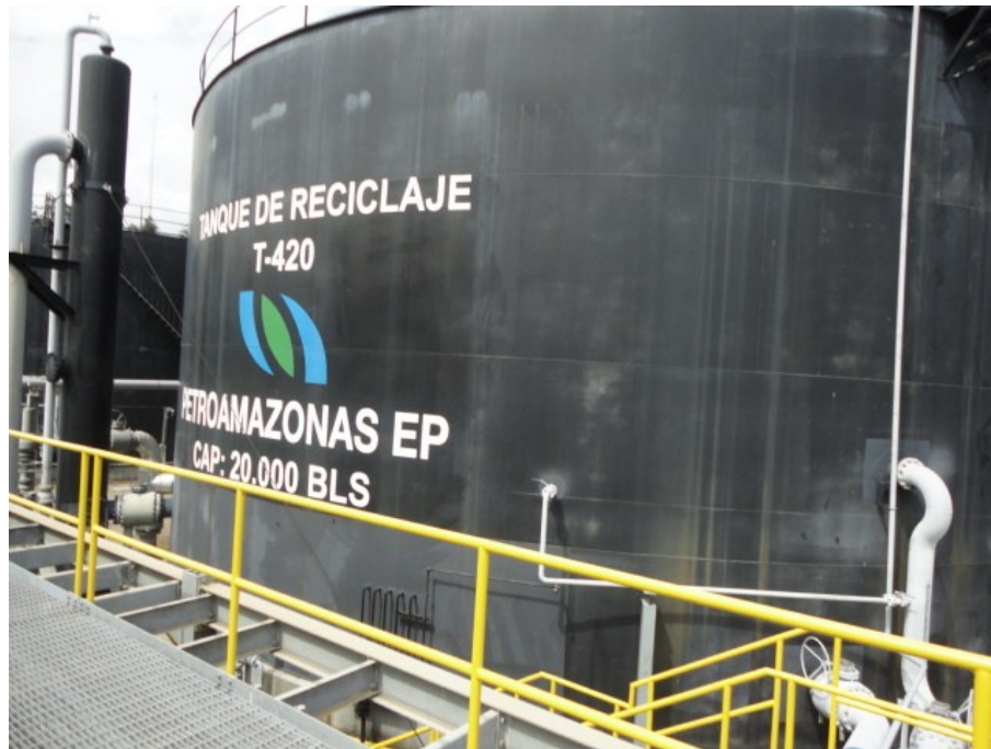
Figura 22. Fotografía de Tanque de Reciclado (T-420).
