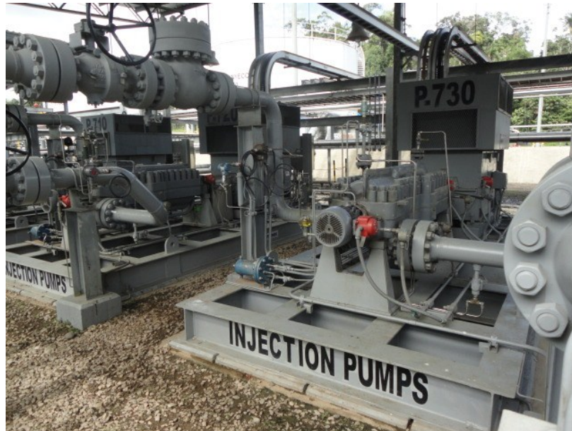
Figura 30. Fotografía de bombas de reinyección de alta presión (P-710/720/730).
