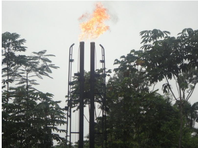
Figura 34. Fotografía de Sistema de teas de alta y baja presión de CPF Yuralpa (Z-650).
