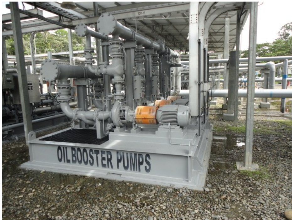
Figura 18. Fotografía de bombas booster de petróleo P-500/510/520
