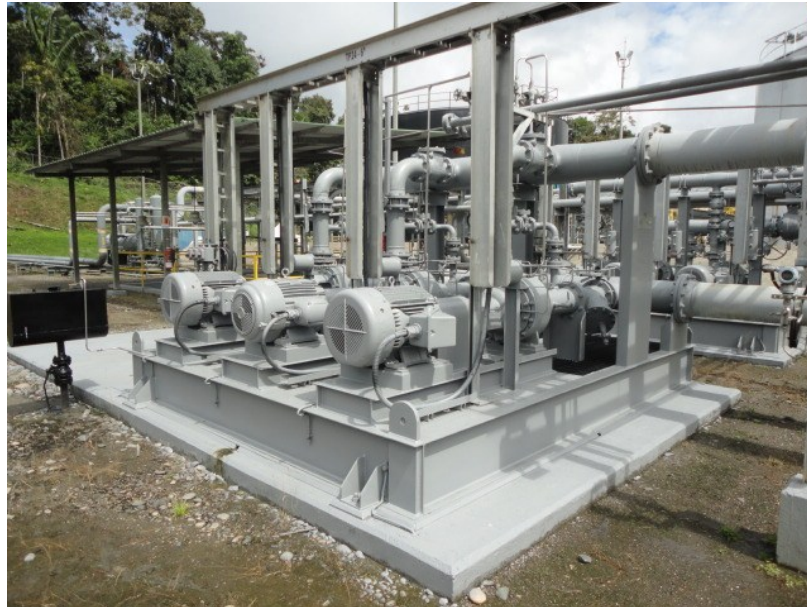
Figura 26. Fotografía de Bombas Transfer P-300/310/320.
