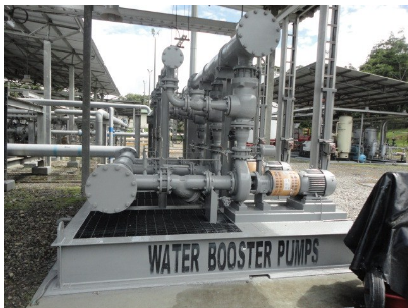
Figura 29. Fotografía de bombas booster de reinyección de agua (P-560 /570/580).
