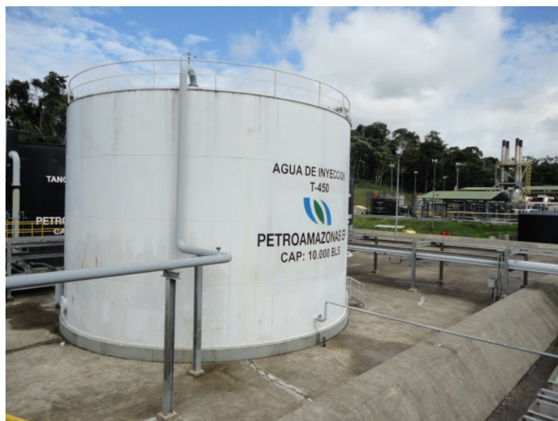
Figura 28. Fotografía de tanque de reinyección de agua (T-450).
