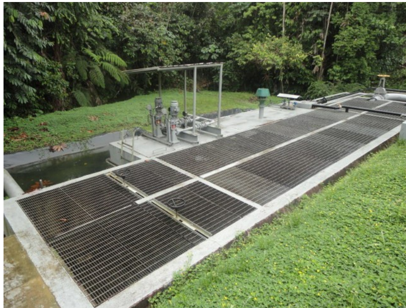
Figura 39. Fotografía de Separador API y Open Drain (T-470).
