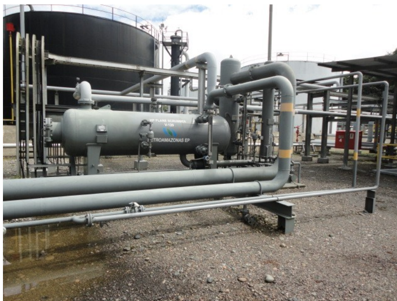
Figura 32. Fotografía de Separador de Gas de Alta Presion (V-120).
