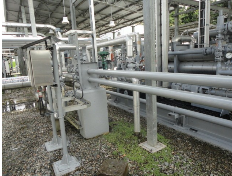
Figura 25. Fotografía de Intercambiador de calor (E-255).
