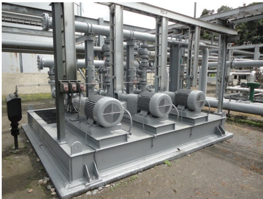
Figura 13. Fotografía de bombas transfer P-330/340/350
