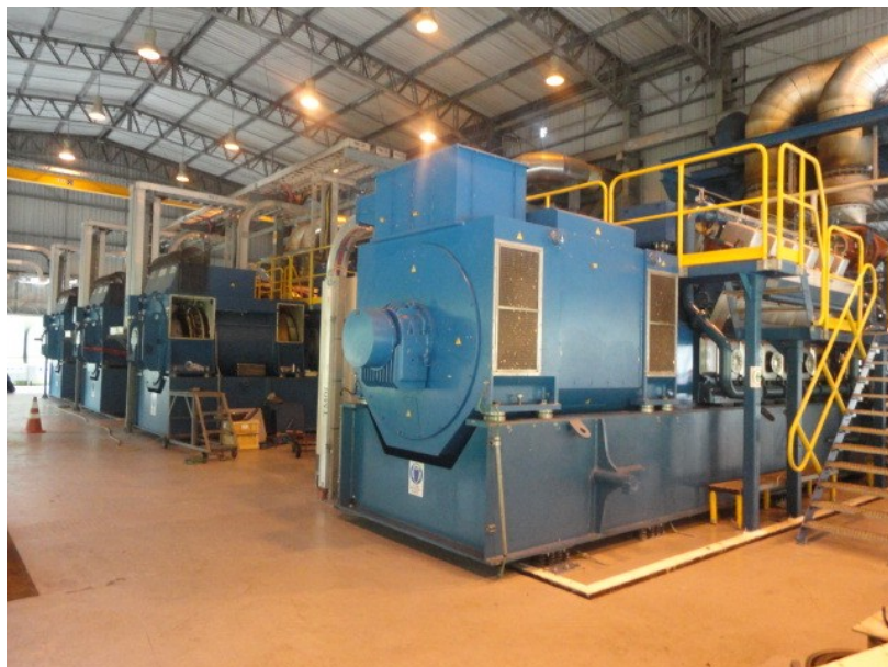
Figura 44. Fotografía de Grupo de Generadores Eléctricos (PGP).
