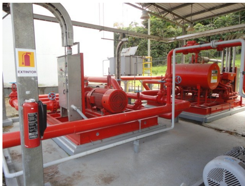
Figura 41. Fotografía de Sistema Contra Incendios (P-880/890).
