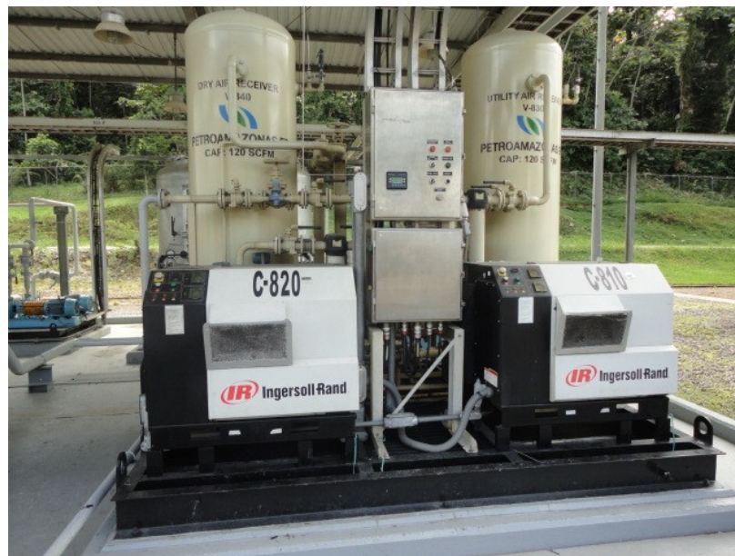
Figura 40. Fotografía de Sistema de Compresores de Aire de Instrumentos y Utilidades (C-810/820).
