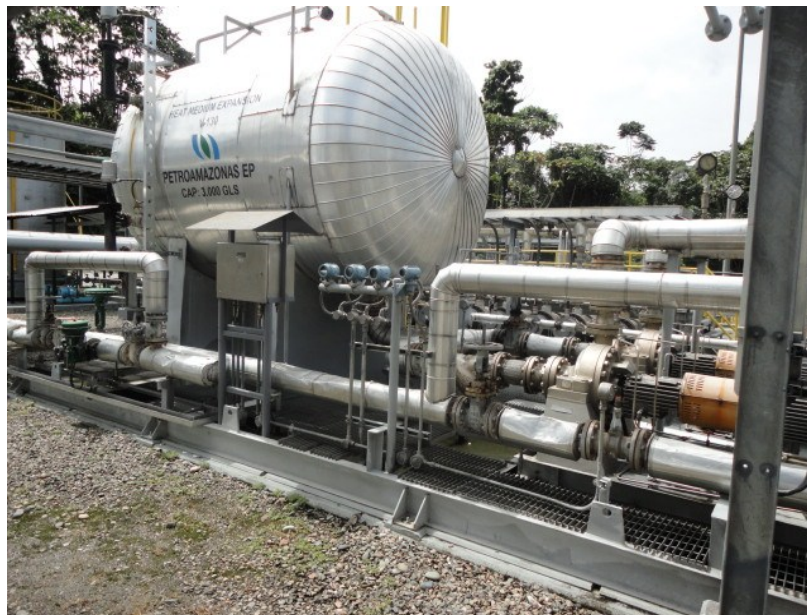
Figura 35. Fotografía de Tanque de Expansión Térmico (V-130) y Sistema de Bombas de Circuito de Aceite Térmico (P-840/850).
