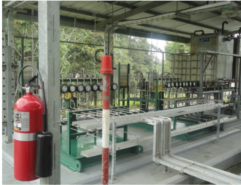
Figura 42. Fotografía de Sistema de almacenamiento e inyección de Químicos.
