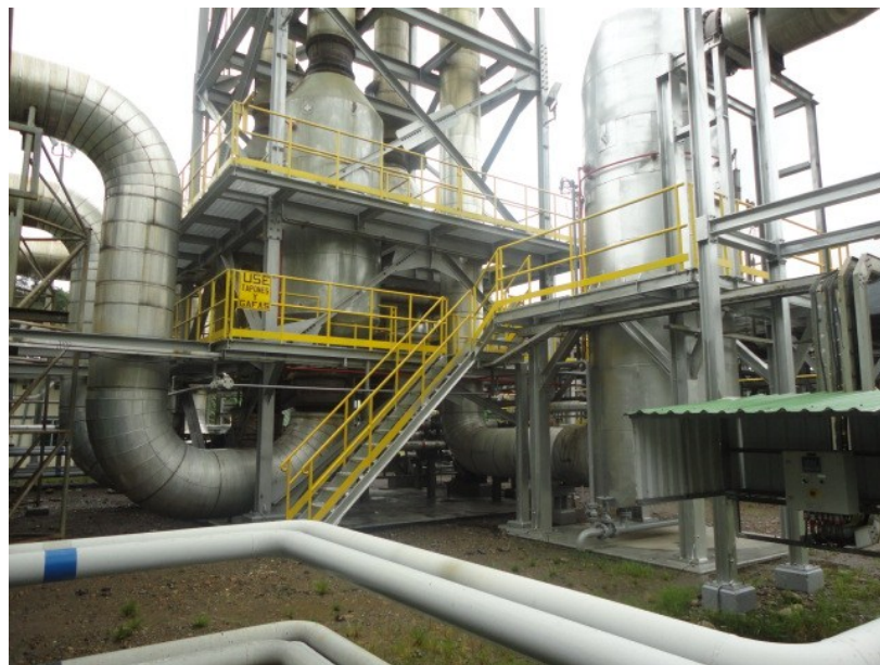
Figura 36. Fotografía de Sistema de Recuperadores de Calor para Aceite Térmico (H900/910/920/930).
