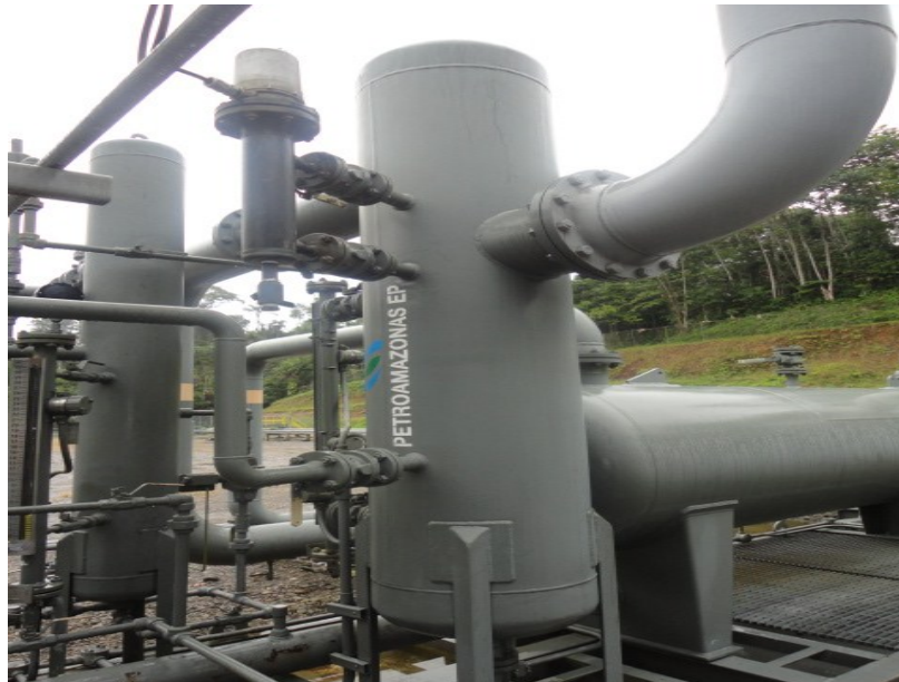
Figura 31. Fotografía de Separador de Gas de Utilidades (V-150).
