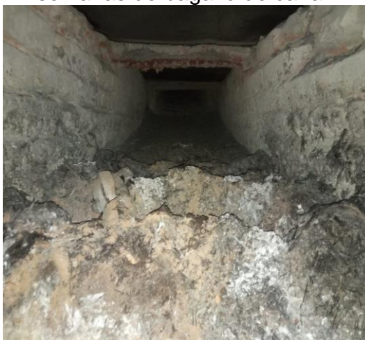
Figura 11. Interior de la chimenea de combustión del bagazo de caña.
