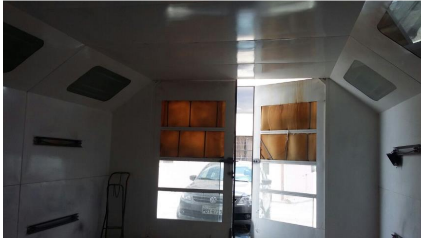
Figura 4. Cabina de proceso de pintado parte interna.
