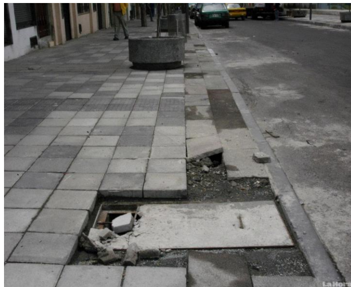
Figura 22. Borde y acera en mal estado (Diario La Hora, 2011)
