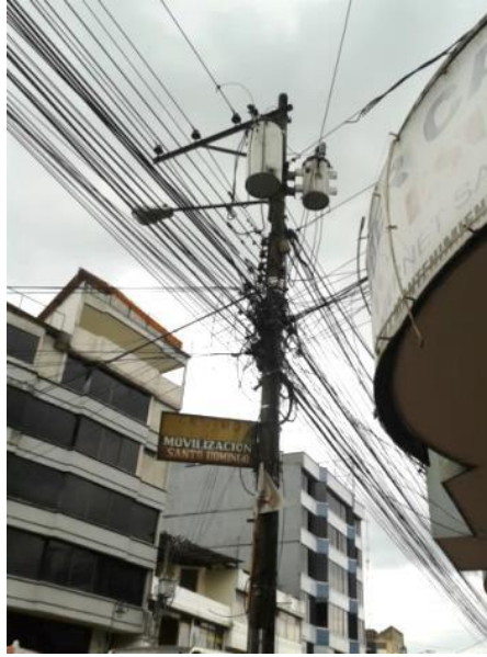
Figura 16. Excesivo Uso de Cableado Eléctrico (Efrain Vizúete J.)
