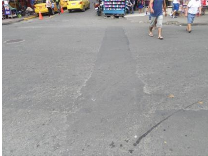
Reparaciones de asfalto en mal estado
