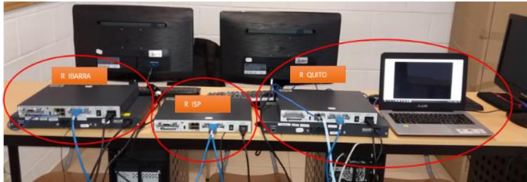
Figura 13. Conexión física de los equipos de networking del prototipo.
