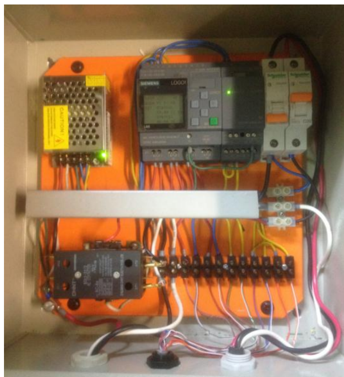
Figura 65. Tablero de Control
