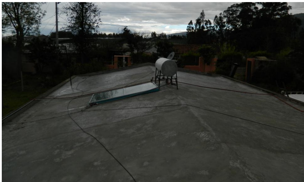
Figura 67. Sistema Colector Solar instalado
