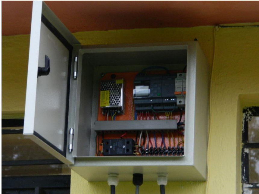
Figura 64. Tablero de control montado sobre la pared de la vivienda
