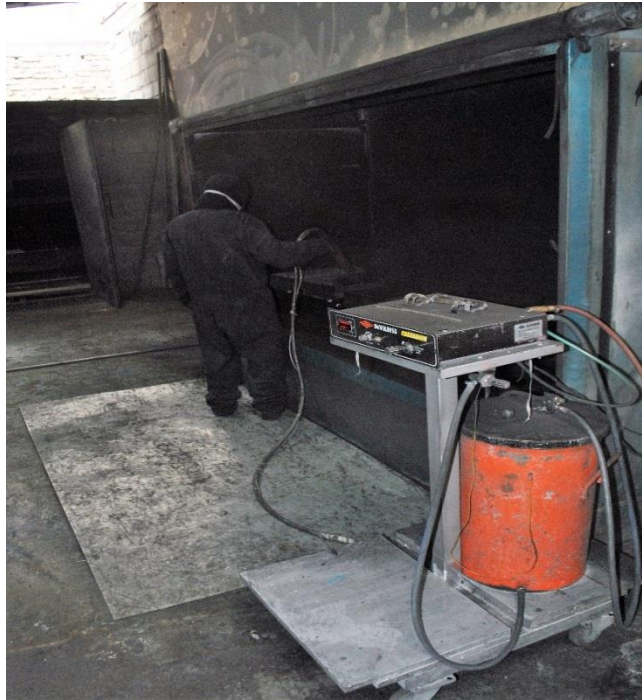
Cámara de Pintura
