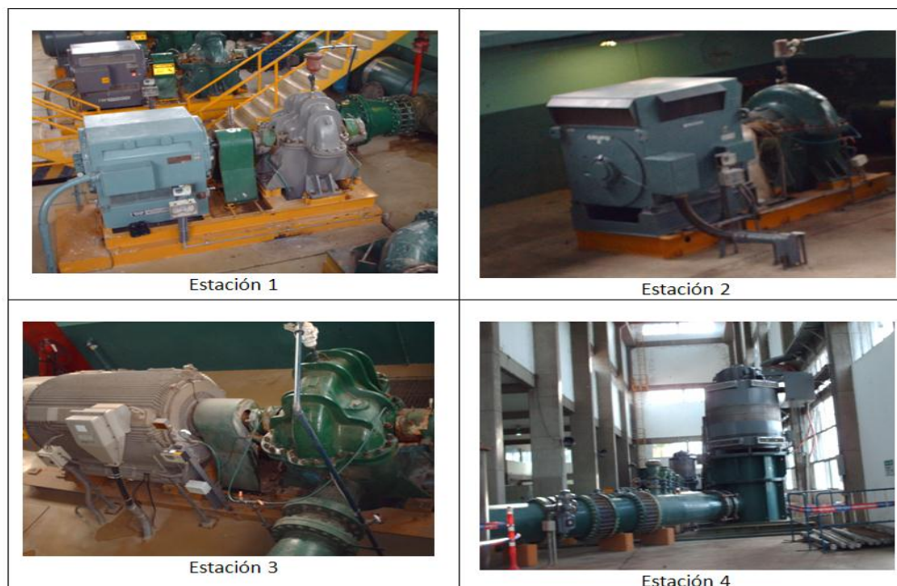
Gráfico 4.11: Bombas de las estaciones de planta La Toma
