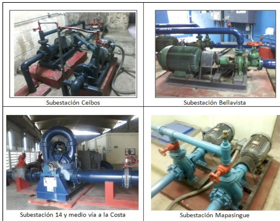
Gráfico 4.10: Bombas de las subestaciones de AAPP.
