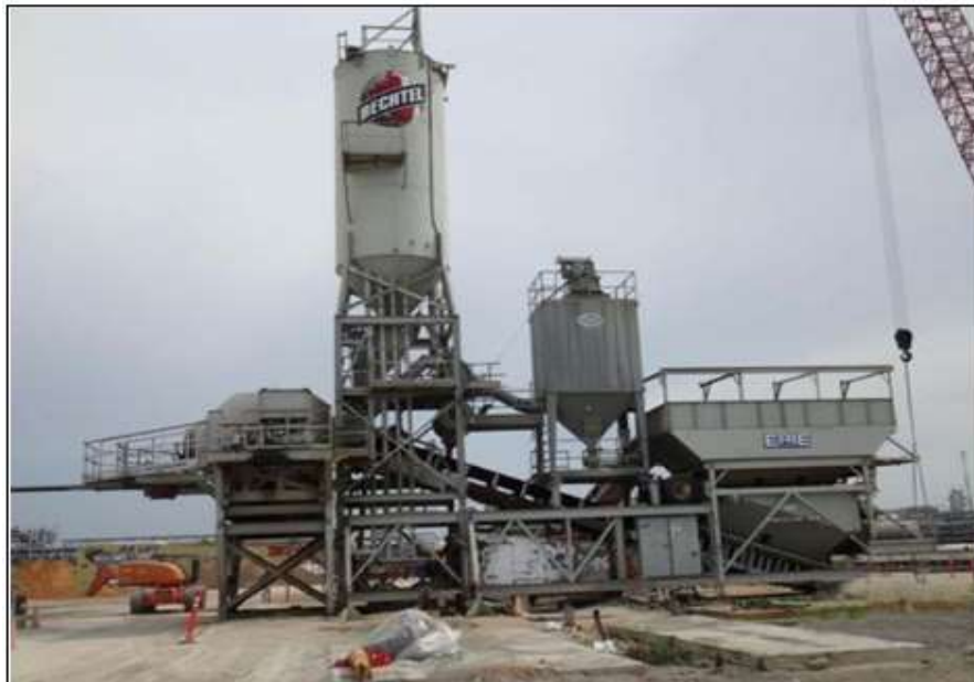
Figura 5.18 – Planta de Hormigón 150 m 3 /hora.
