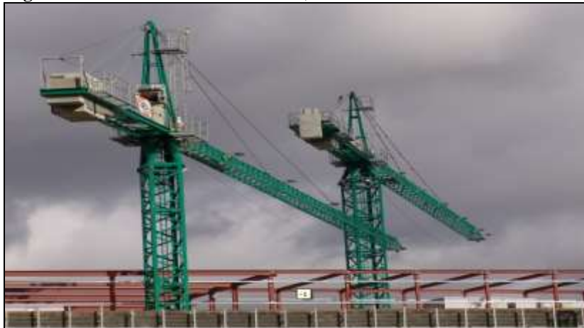
Figura 5.10 – Grúa Torre 22Ton18MT, Marca JASO.
