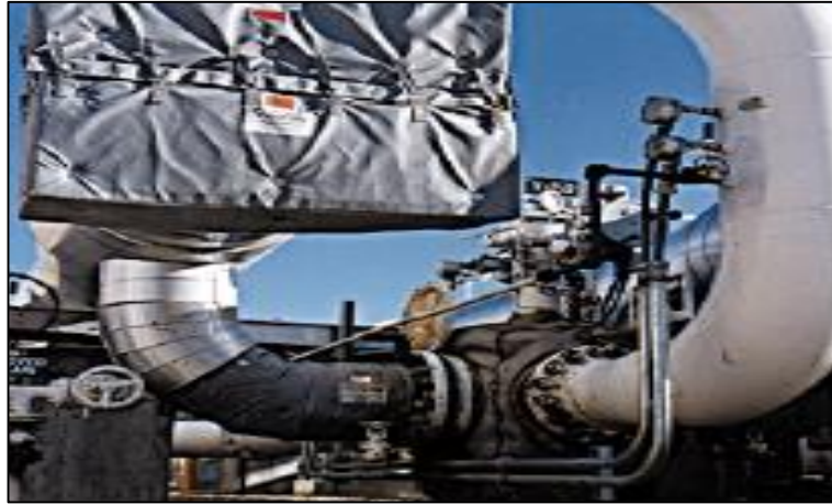
Figura 34. Válvula de Cuatro Vías en una unidad LACT. Fuente: Programa de Entrenamiento para Operaciones de Ductos. (2014).
