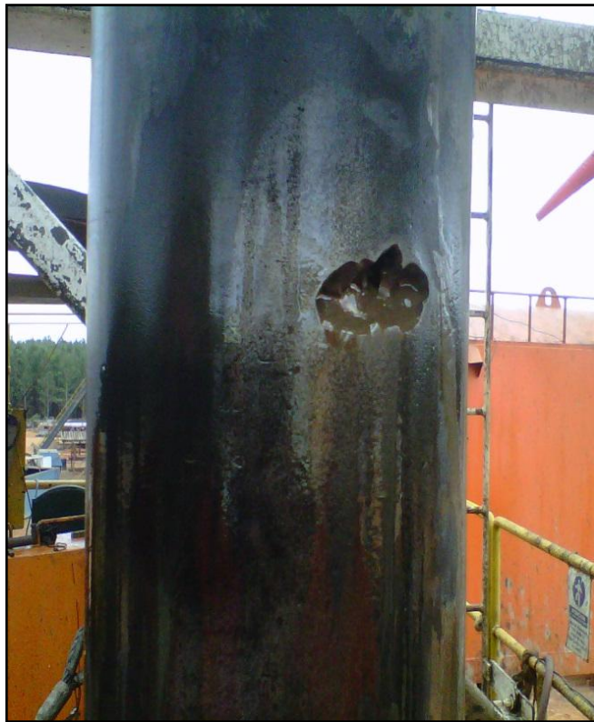
Figura 3. Tubería con grietas
