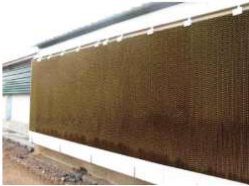
Figura 4. Sistema de refrigeración
