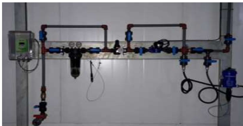
Figura 21. Interior de galpón, tablero de agua
