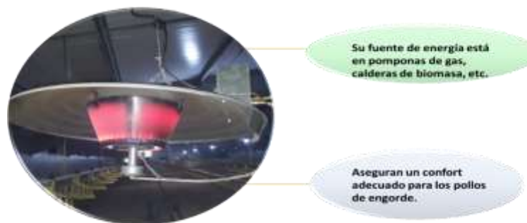
Figura 5. Sistema de calefacción
