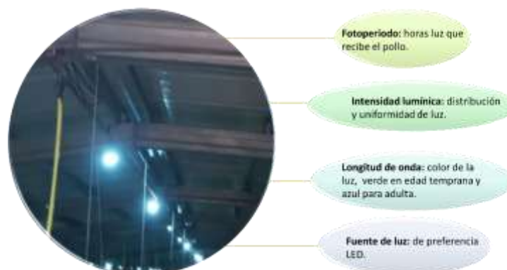
Figura 6. Sistema de iluminación
