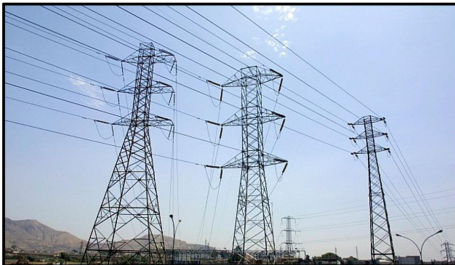
Figura 1. Líneas eléctricas de transmisión
