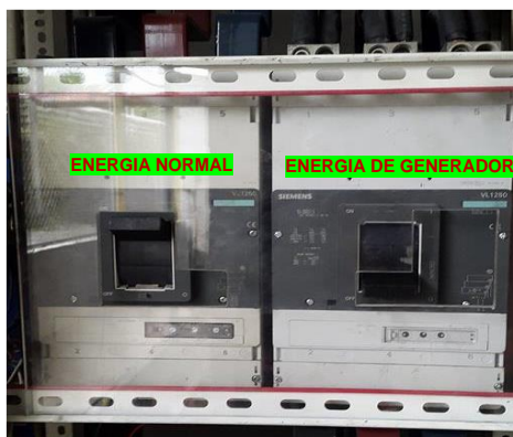
Figura 35: Breakers de conmutación de transferencia de energía eléctrica.
