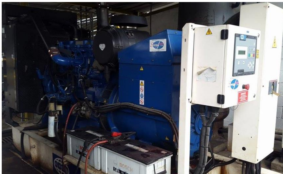
Figura 14: Grupo electrógeno FG WILSON P400E5
