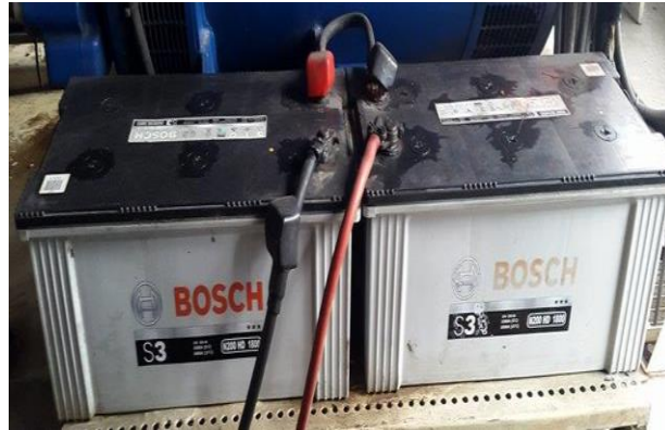
Figura 16: Conexión de Baterías de grupo electrógeno.
