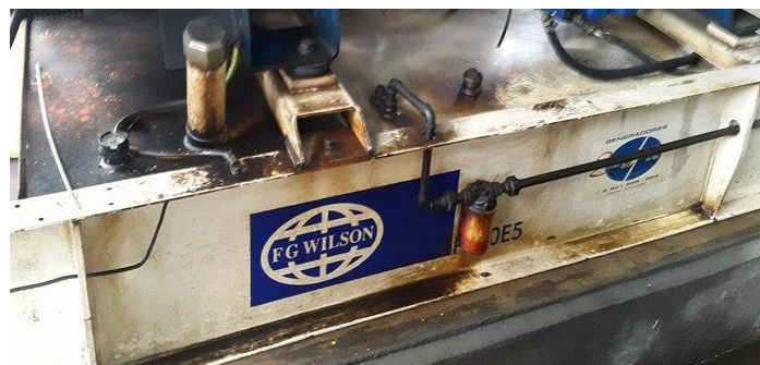
Figura 19: Apariencia física de bancada de grupo electrógeno.
