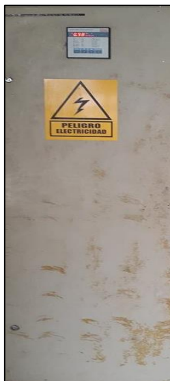
Figura 25 : Estructura externa de tablero de distribución principal.
