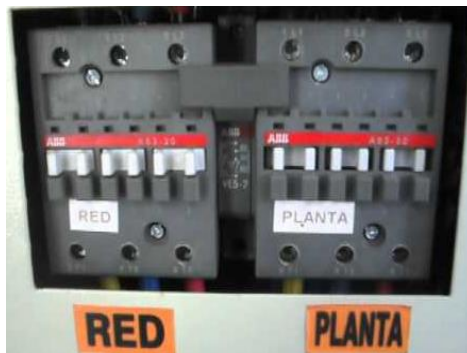
Figura 36: contactores principales con restricción mecánica Fuente: Transferencia. Avi, 2012, p1.
