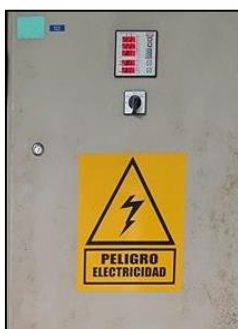
Figura 26: Señalética de un tablero de distribución principal.
