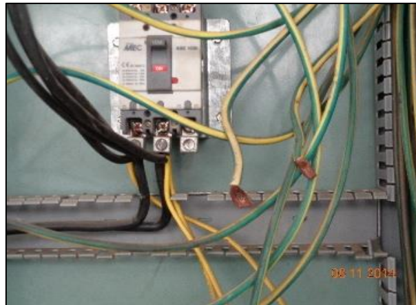
Ilustración N° 9 Riesgo Eléctrico En El Tablero Del Bloque B
