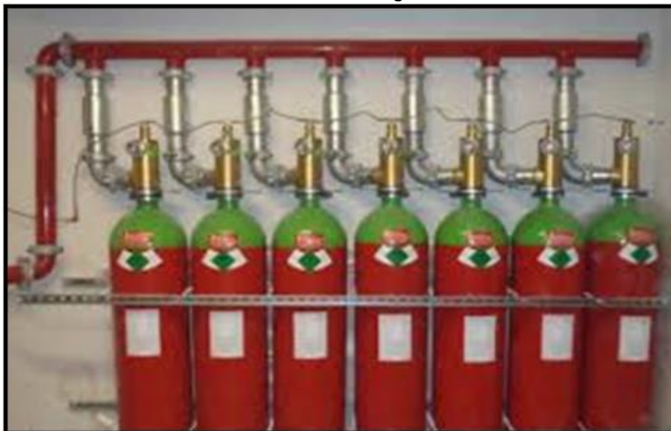
Ilustración Nº 55 Sistema De Extinción Por Agentes Gaseosos
