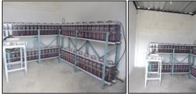
Figura N° 4.43. Cuarto de baterías sin extractor
