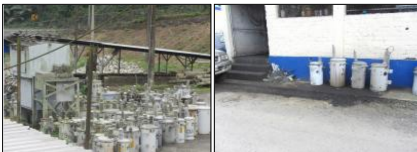
Figura N° 4.22. Transformadores de distribución dañados
