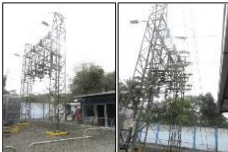
Figura N° 4.221. Pórtico de 69 KV
