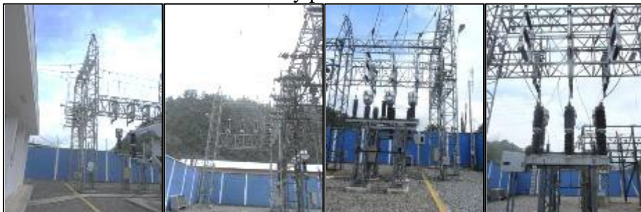
Figura N° 4.58. Acometida y pórtico de 69KV
