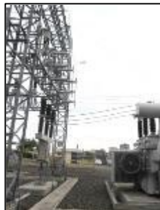
Figura N° 4.195. Alimentación de 69 KV a transformador de potencia
