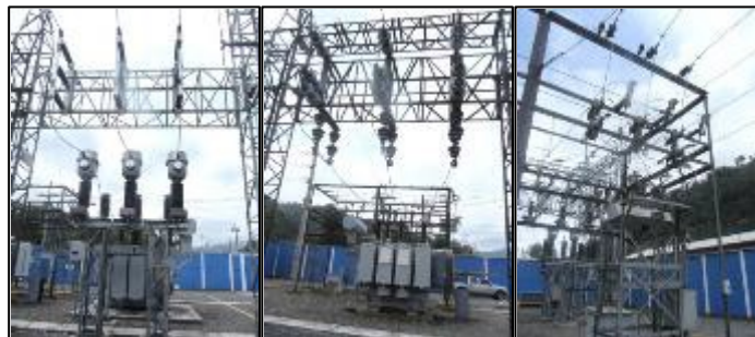
Figura N° 4.59. Protecciones de 69KV
