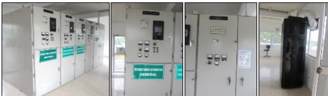
Figura N° 4.155. Sala de control
