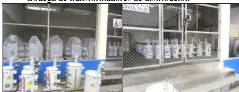
Figura N° 4.20. Bodega de transformadores de distribución
