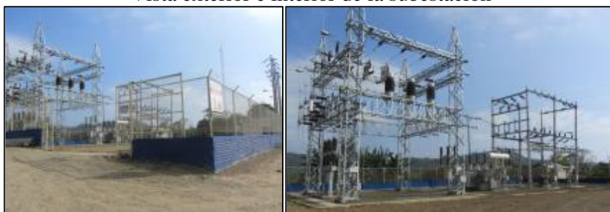
Figura N° 4.179. Vista exterior e interior de la subestación
