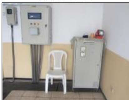
Figura N° 4.91. Sala de control
