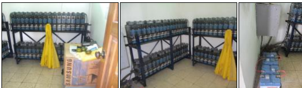
Figura N° 4.94. Materiales dentro del cuarto de baterías
