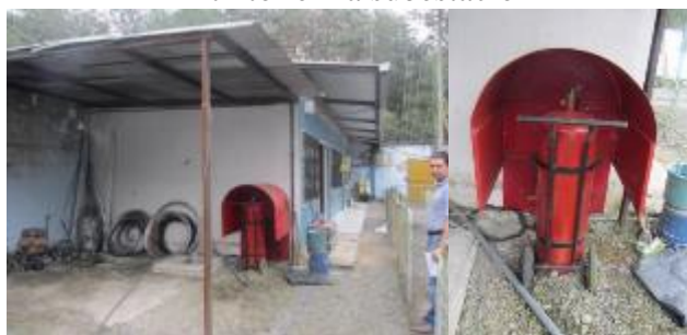
Figura N° 4.230. Extintor en la subestación
