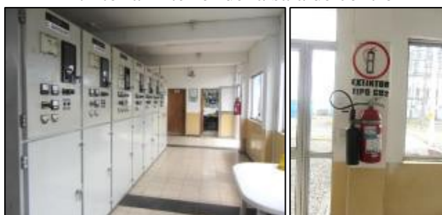
Figura N° 4.96. Extintor al interior de la sala de control
