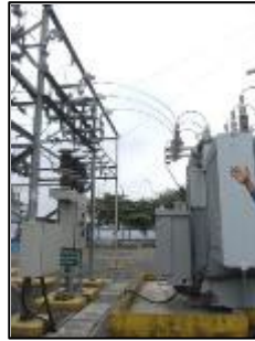
Figura N° 4.36. Salida de 13.8 KV desde transformador de potencia
