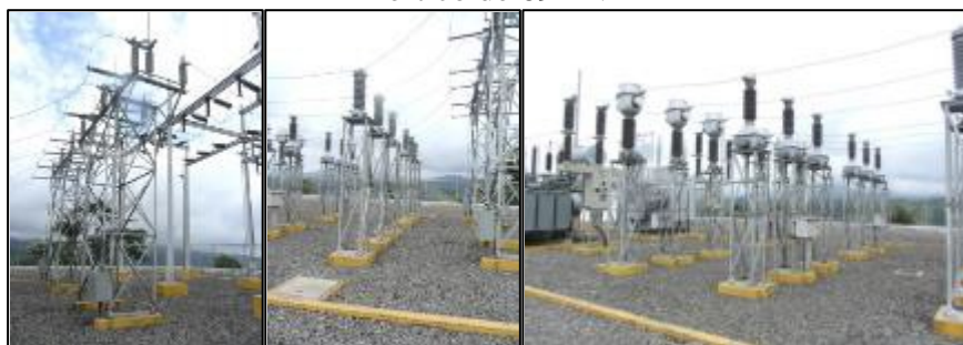
Figura N° 4.73. Pórtico de 69 KV
