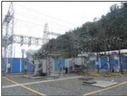
Figura N° 4.57. Vista interior de la subestación
