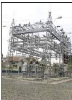
Figura N° 4.197. Pórtico de 13.8 KV
