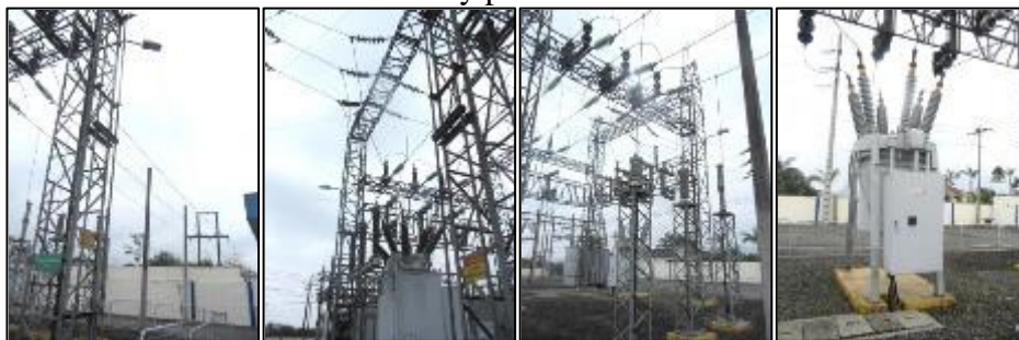
Figura N° 4.101. Acometida y pórtico de 69 KV
