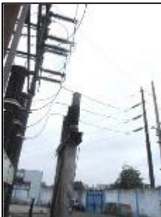
Figura N° 4.84. Acometida de 69 KV
