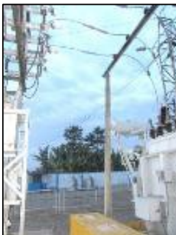
Figura N° 4.209. Salida de 13.8 KV desde transformador de potencia
