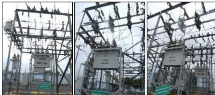
Figura N° 4.39. Reconectores de alimentadores
