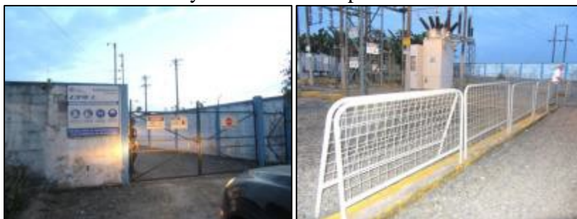
Figura N° 4.216. Señalización y cerramiento de patio de maniobras
