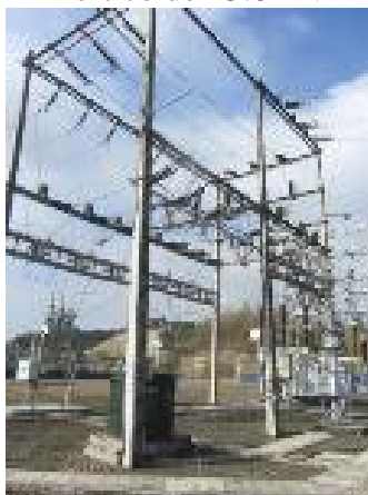
Figura N° 4.185. Pórtico de 13.8 KV
