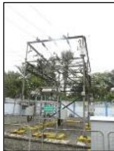
Figura N° 4.225. Pórtico de 13.8 kV
