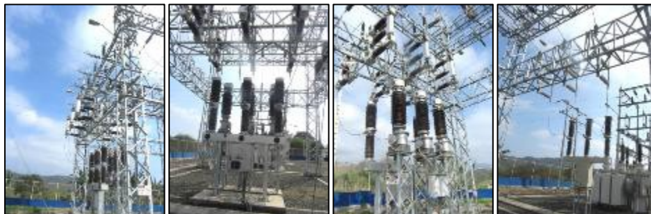
Figura N° 4.181. Protecciones DE 69 KV
