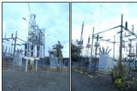
Figura N° 4.206. Pósito de 69 KV
