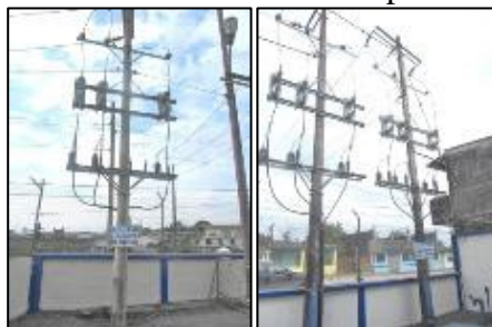
Figura N° 4.121. Salida de 13.8KV desde postes
