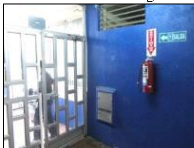
Figura N° 4.235. Extintor con señalización en ingreso a edificios
