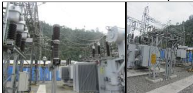
Figura N° 4.60. Alimentación de 69KV a transformador de potencia
