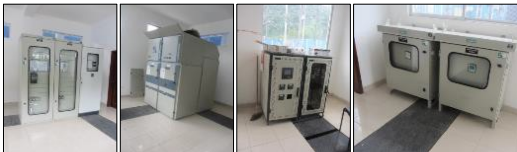
Figura N° 4.66. Sala de control
