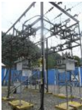
Figura N° 4.63. Pórtico de 13.8KV
