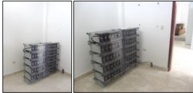
Figura N° 4.80. Cuarto de baterías
