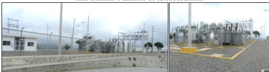
Figura N° 4.71. Vista exterior e interior de la subestación
