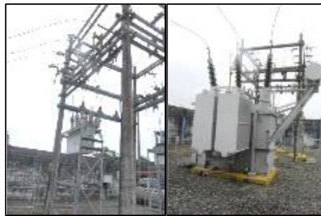
Figura N° 4.48. Pórtico de 69KV alimentación a transformador
