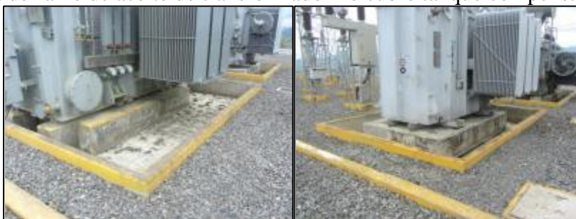
Figura N° 4.76. Cubeto para derrame de aceite de transformador no cubre tanque compensador de aceite
