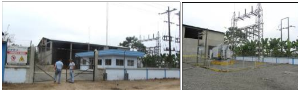
Figura N° 4.147. Vista exterior e interior de la subestación
