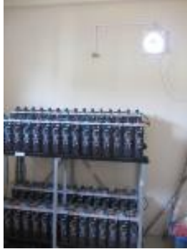
Figura N° 4.189. Cuarto de baterías
