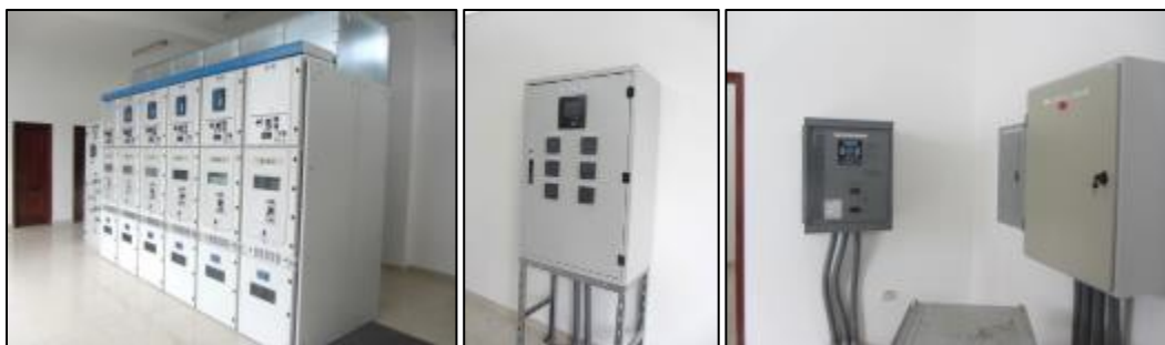
Figura N° 4.79. Sala de control
