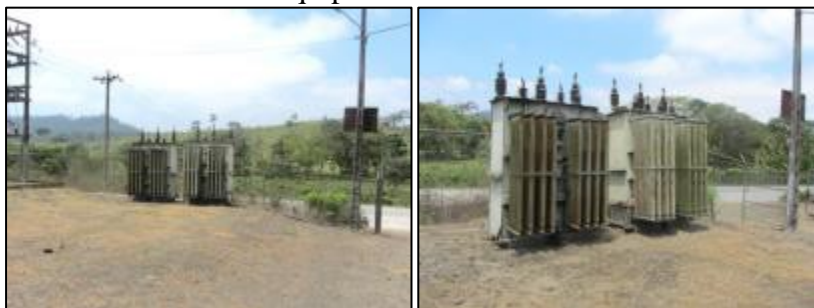
Figura N° 4.176. Equipos en mal estado
