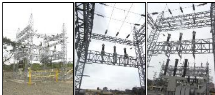
Figura N° 4.194. Pórtico de 69 KV
