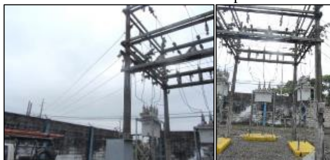
Figura N° 4.53. Salida de alimentadores a postes
