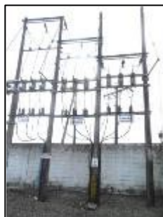
Figura N° 4.90. Salida de 13.8kv desde postes
