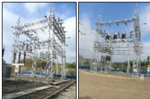
Figura N° 4.181. Pórtico de 69 KV
