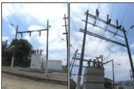
Figura N° 4.168. Alimentación de 69 KV a transformador de potencia
