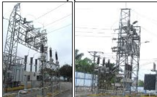
Figura N° 4.34. Acometida y pórtico de 69 KV
