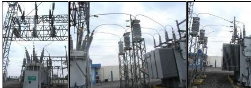
Figura N° 4.102. Alimentación de 69 KV a transformador de potencia
