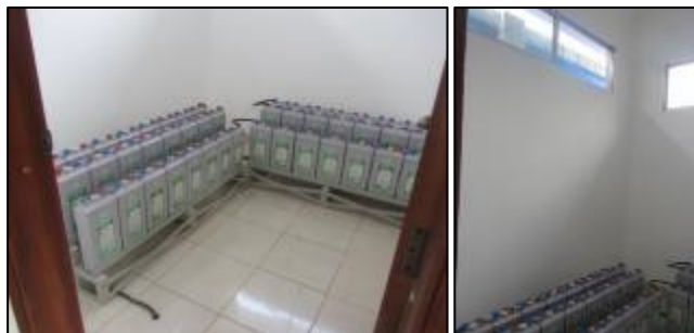
Figura N° 4.67. Cuarto de baterías
