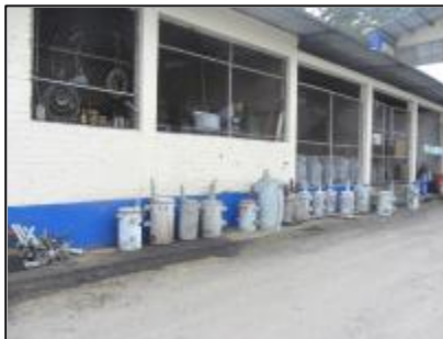
Figura N° 4.11. Transformadores a revisión
