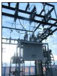
Figura N° 4.210. Pórtico de 13.8 KV
