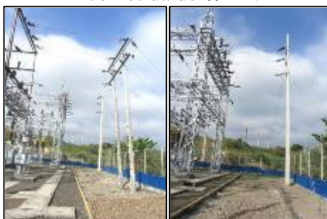
Figura N° 4.180. Acometida de 69 KV
