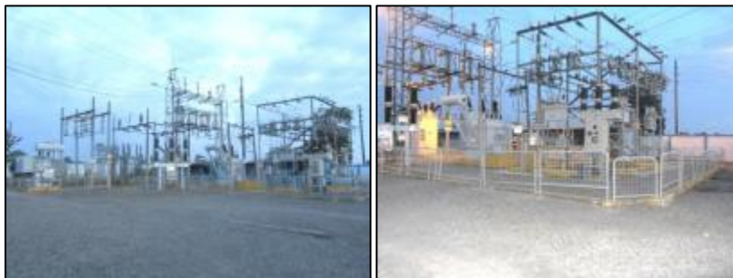
Figura N° 4.205. Vista interior de la subestación
