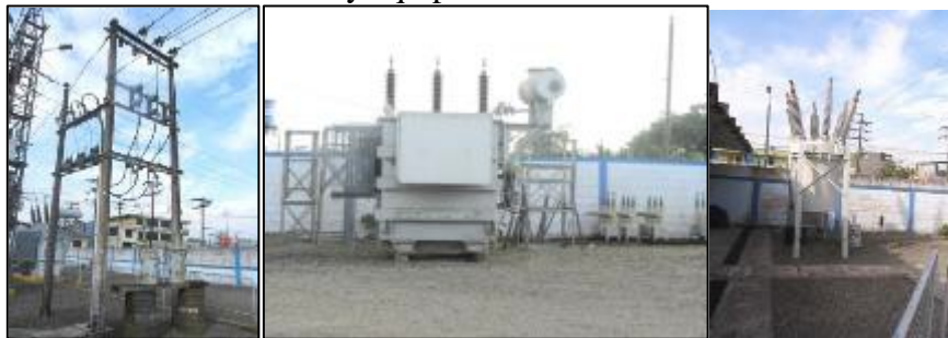
Figura N° 4.1.39. Basura y equipos fuera de servicio
