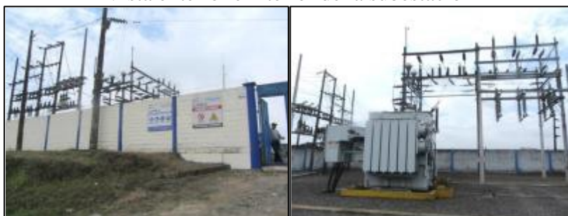
Figura N° 4.83. Vista exterior e interior de la subestación
