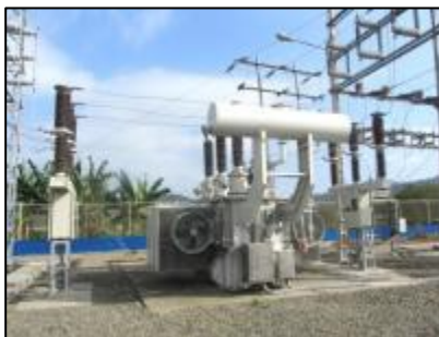
Figura N° 4.182. Alimentación de 69 KV a transformador de potencia
