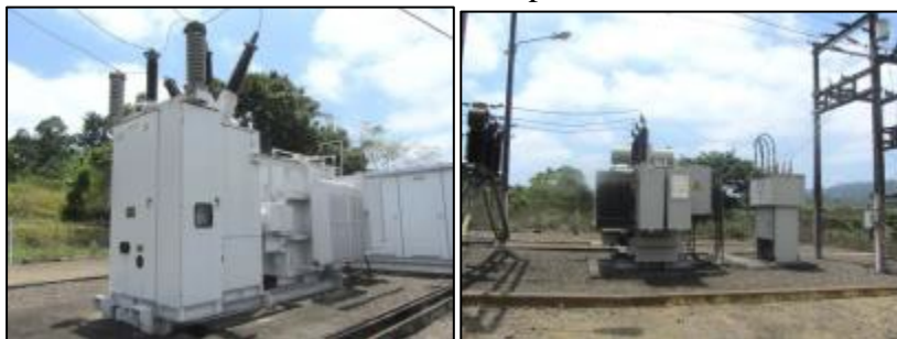
Figura N° 4.170. Transformador de potencia
