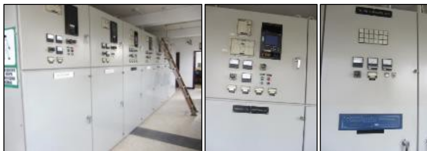
Figura N° 4.122. Paneles en sala de control
