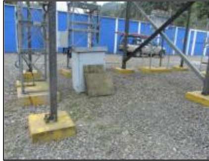
Figura N° 4.69. Basura, equipos en mal estado
