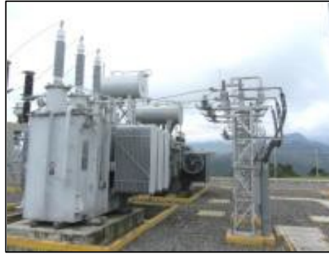
Figura N° 4.77. Salida de 13.8KV desde transformador de potencia
