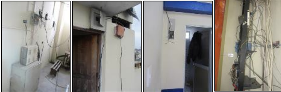
Figura N° 4.261. Instalaciones eléctricas defectuosas
