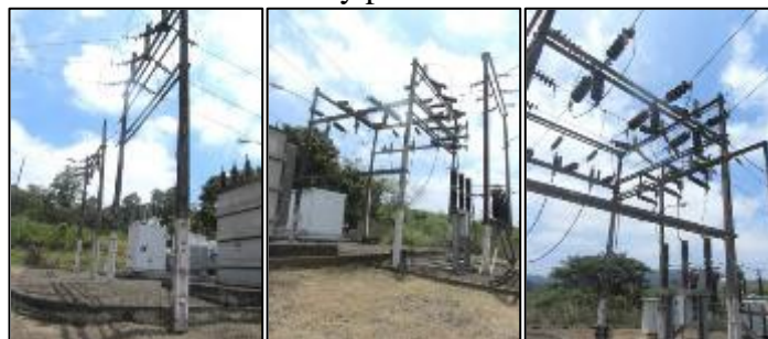
Figura N° 4.167. Acometida y pórtico de 69 KV
