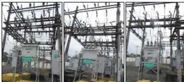
Figura N° 4.107. Reconectores con identificación de alimentadoras
