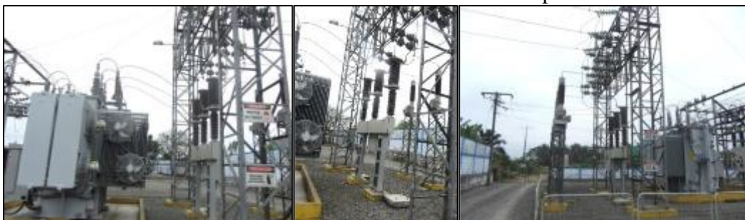
Figura N° 4.35. Alimentación de 69 kv a transformadores de potencia
