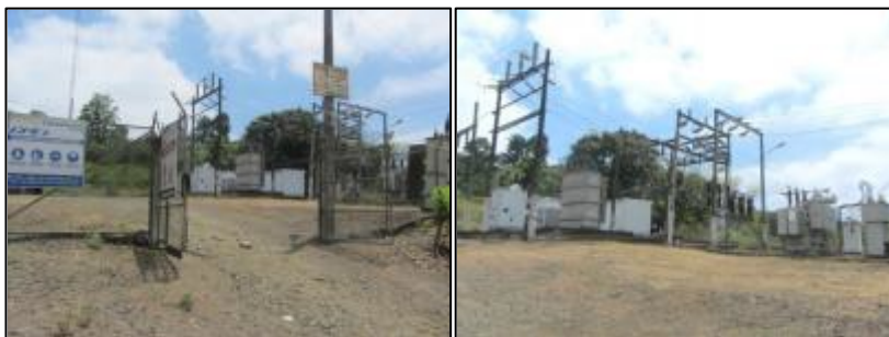
Figura N° 4.166. Vista exterior e interior de la subestación
