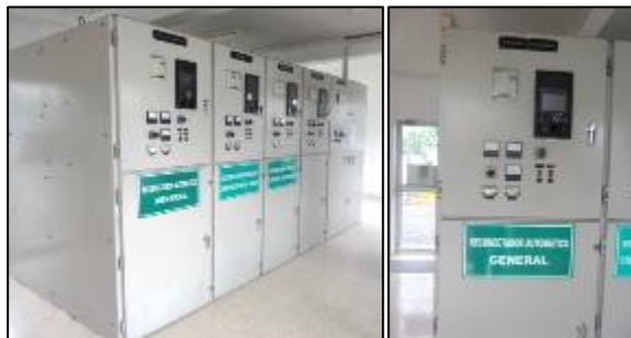
Figura N° 4.164. Señalización en cuarto de control
