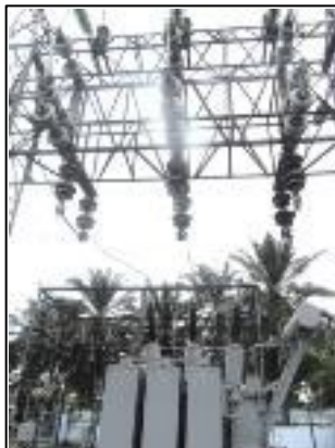
Figura N° 4.222. Alimentación de 69 KV a transformador de potencia
