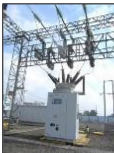
Figura N° 4.128. Acometida de 69 KV
