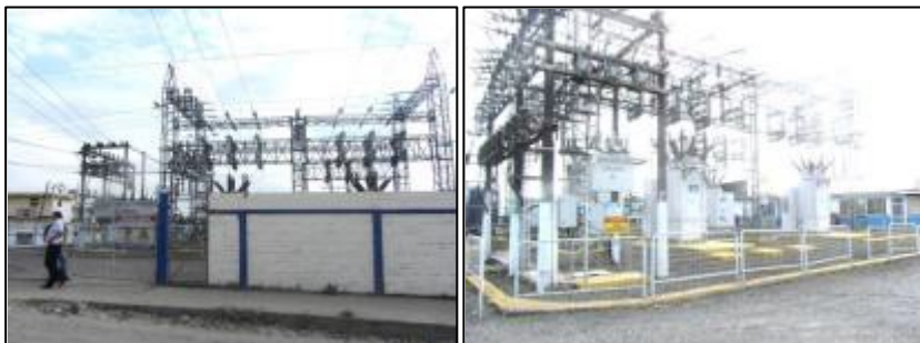
Figura N° 4.127. Vista exterior e interior de la subestación
