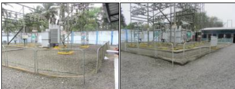
Figura N° 4.219. Vista interior de la subestación
