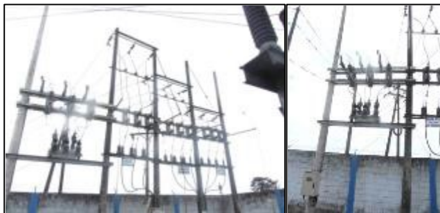
Figura N° 4.88. Pórtico de 13.8 KV salida de 13.8KV
