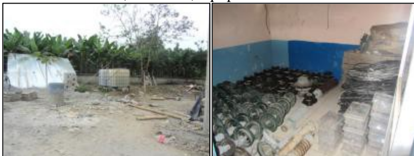
Figura N° 4.157. Basura, desechos, equipos en mal estado
