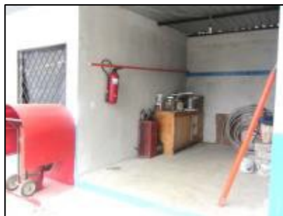
Figura N° 4.44. Extintor de la subestación
