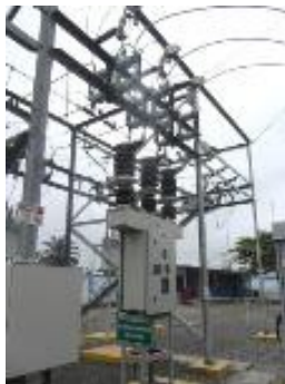
Figura N° 4.38. Pórtico de 13.8 KV
