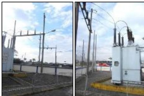
Figura N° 4.118. Acometida de 69 KV
