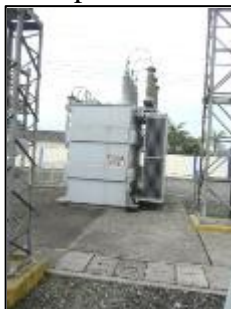
Figura N° 4.104. Transformador de potencia fuera de servicio
