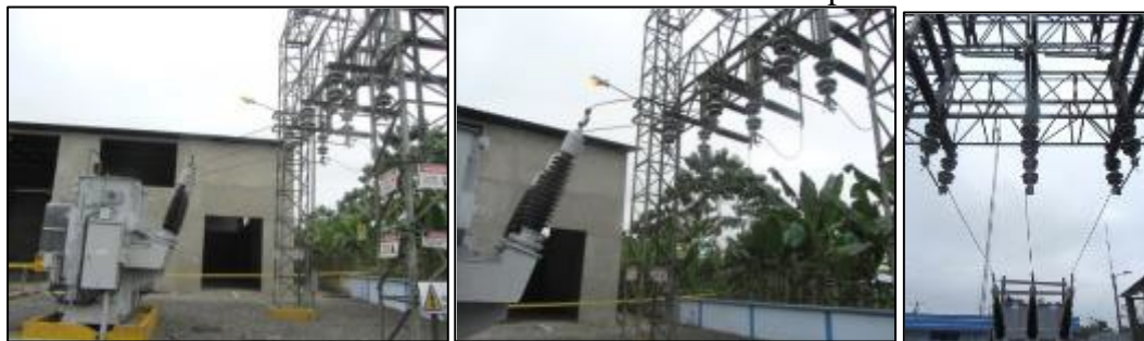
Figura N° 4.150. Alimentación de 69 KV a transformador de potencia
