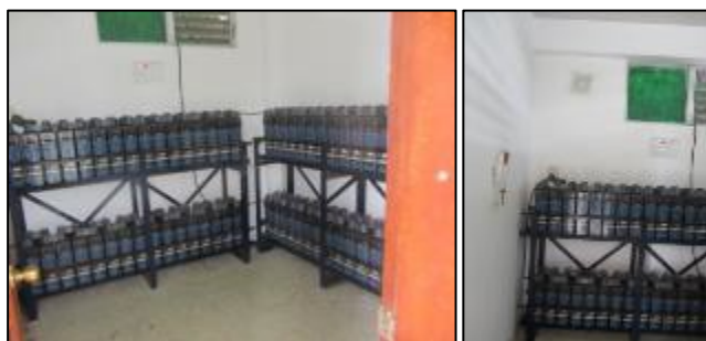
Figura N° 4.156. Cuarto de baterías
