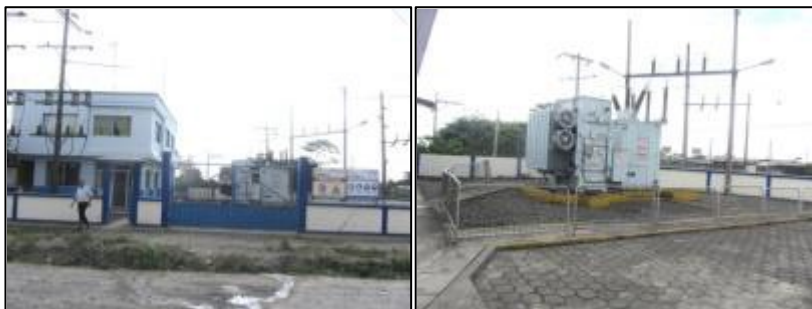
Figura N° 4.117. Vista exterior e interior de la subestación
