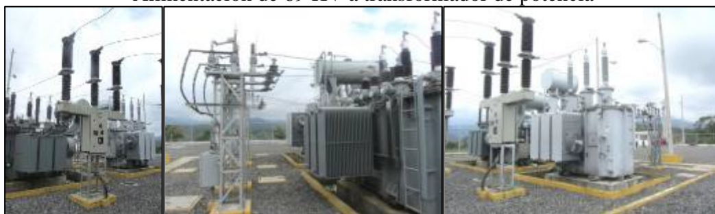
Figura N° 4.74. Alimentación de 69 KV a transformador de potencia
