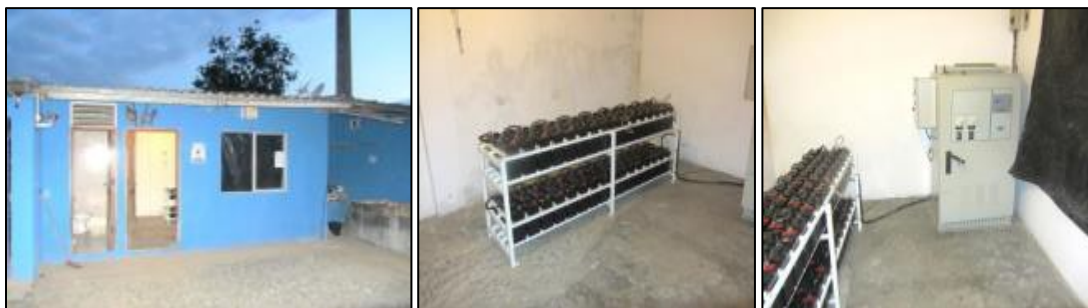
Figura N° 4.212. Cuarto de baterías
