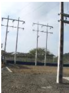
Figura N° 4.187. Salida de alimentadoras a postes
