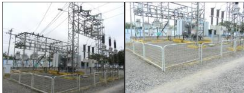
Figura N° 4.33. Vista interior de la subestación
