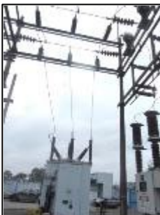
Figura N° 4.86. Alimentación de 69 KV a transformador de potencia
