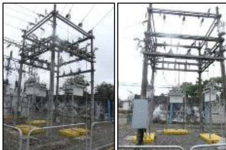
Figura N° 4.51. Pórtico de 13.8KV
