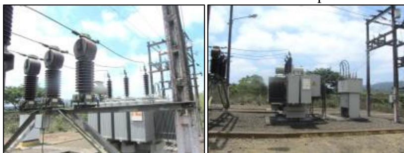
Figura N° 4.169. Alimentación de 69KV a transformador de potencia
