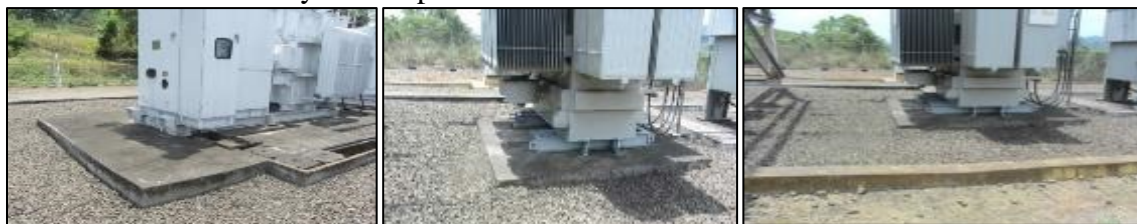
Figura N° 4.171. No hay cubeto para derrame de aceite de transformador
