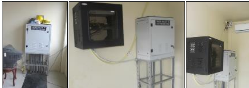
Figura N° 4.200. Sala de control
