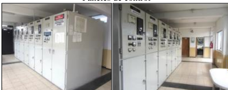
Figura N° 4.92. Paneles de control
