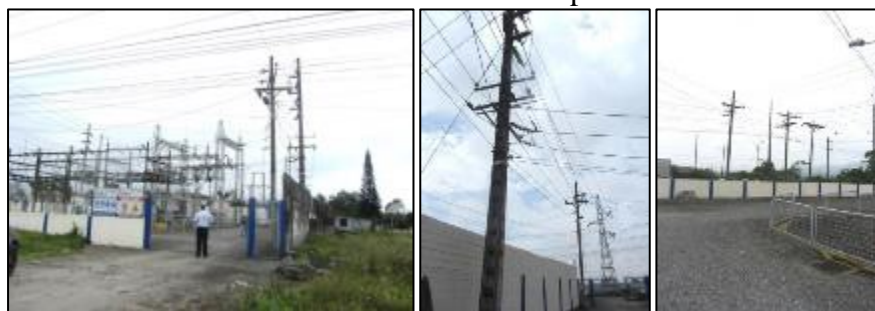
Figura N° 4.109. Salida de 13.8 KV desde postes
