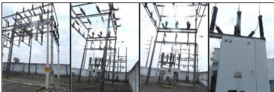
Figura N° 4.85. Pórtico de 69 KV
