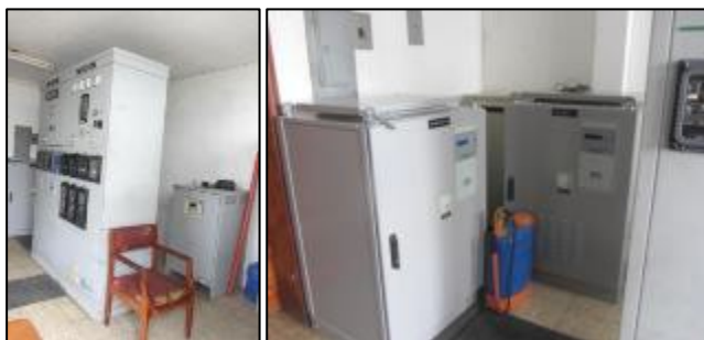
Figura N° 4.111. Sala de control
