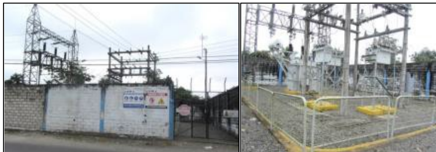
Figura N° 4.47. Vista exterior e interior de la subestación
