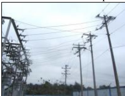
Figura N° 4.41. Salida de 13.8 KV desde postes
