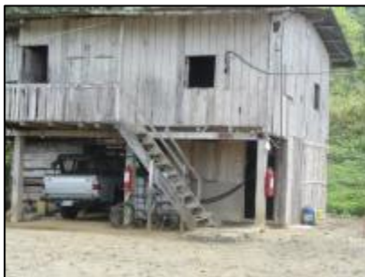
Figura N° 4.177. Extintores en la subestación
