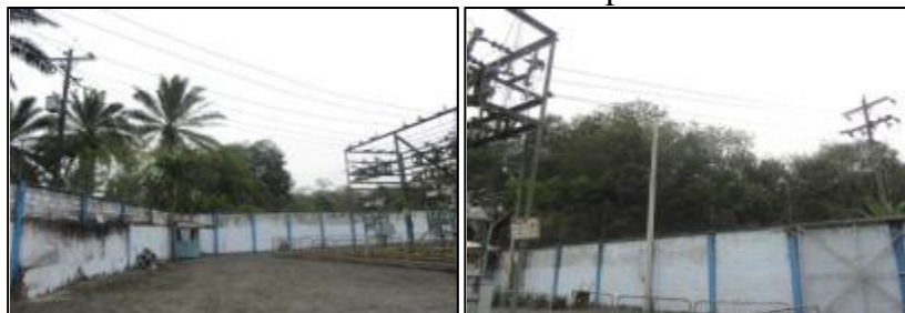
Figura N° 4.227. Salida de alimentadoras a postes
