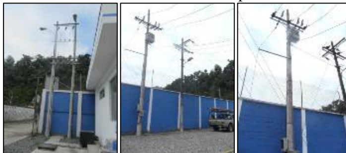
Figura N° 4.65. Salida de 13.8 KV desde postes
