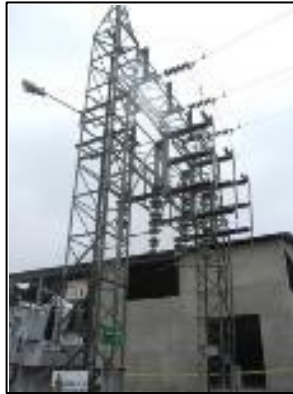
Figura N° 4.149. Pórtico de 69 KV
