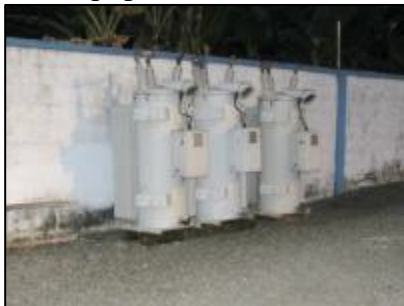
Figura N° 4.214. Equipos en mal estado
