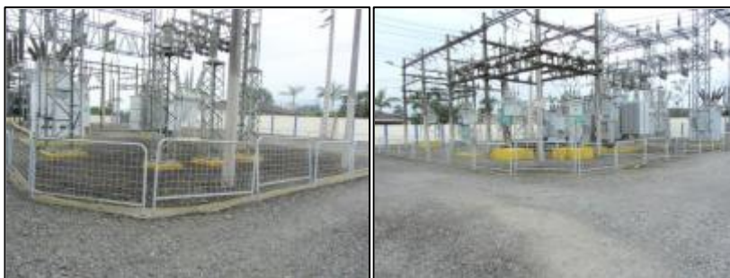
Figura N° 4.100. Vista interior de la subestación con cerramiento
