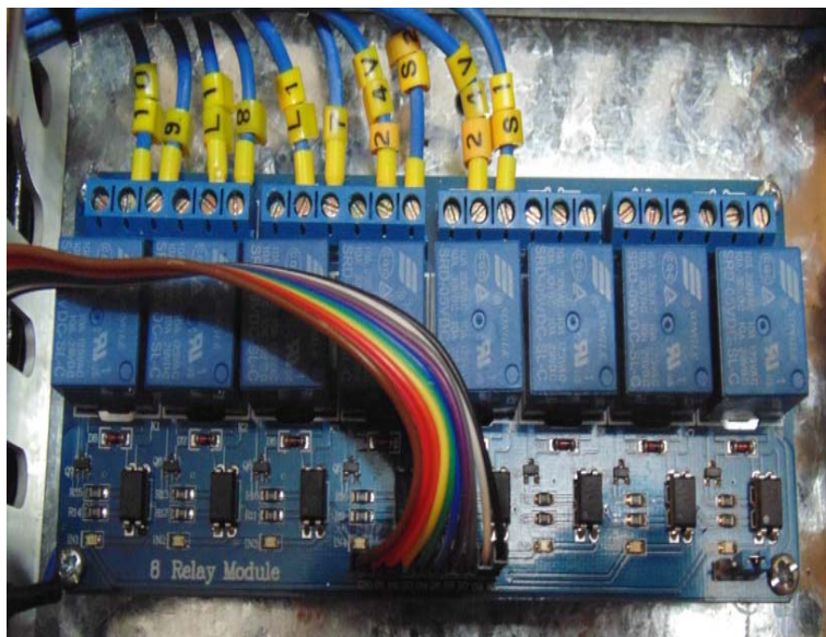
Figura N. 55 Modulo de 8 relés
