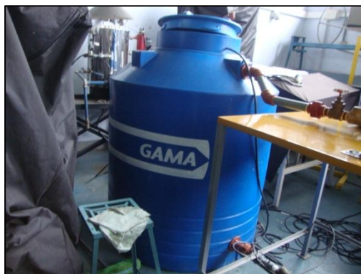
Tanque de abastecimiento
