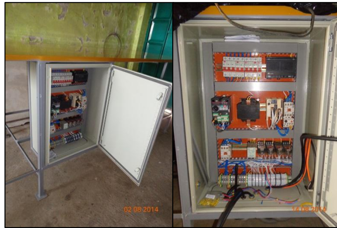
Gráfico N° 4.22 Reingeniería - Tablero eléctrico
