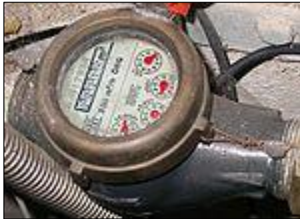
Gráfico N° 2.11 Medidor de caudal
