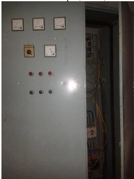
Figura N° 3.21 Tablero de Distribución Principal (cerrado) - Transformador 3
