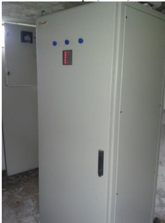
Figura N° 3.19 Tablero de Distribución Principal (cerrado) - Transformador 2
