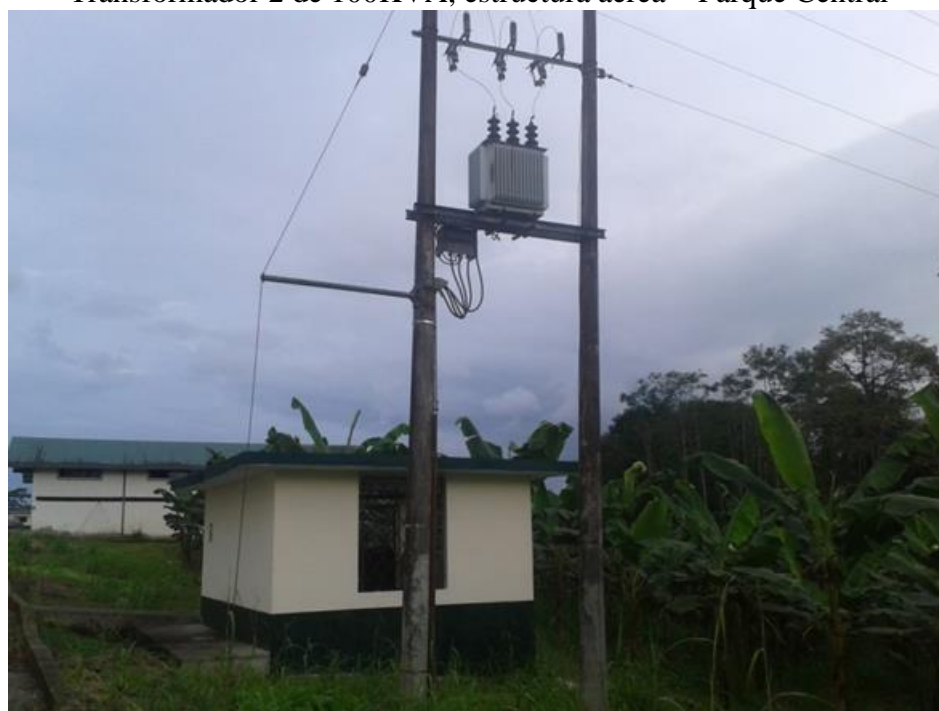
Figura N° 3.16 Transformador 2 de 100KVA, estructura aérea – Parque Central
