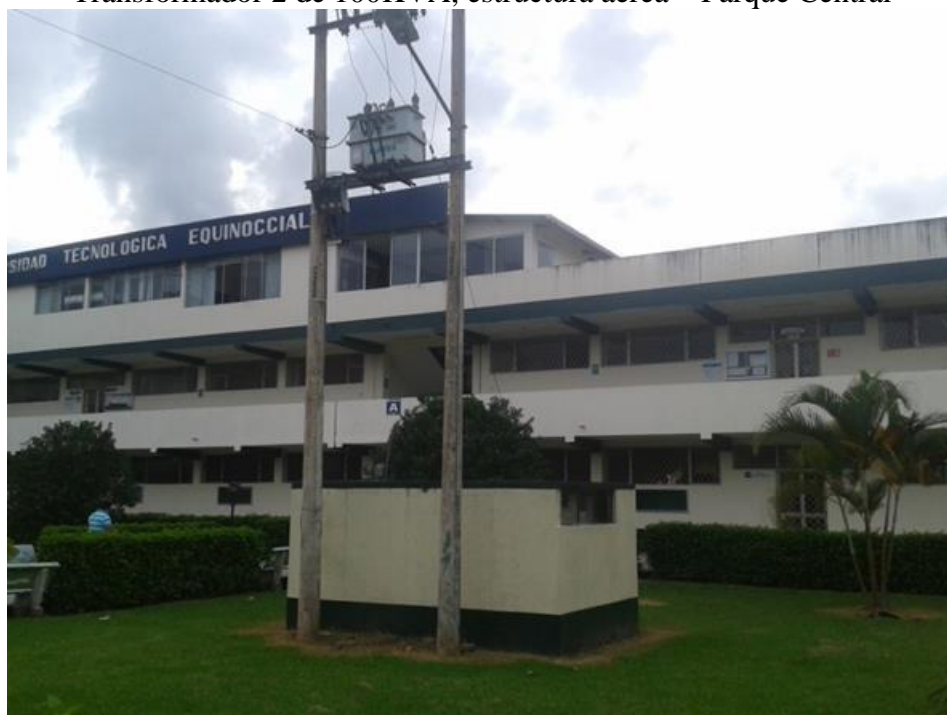
Figura N° 3.15 Transformador 2 de 100KVA, estructura aérea – Parque Central
