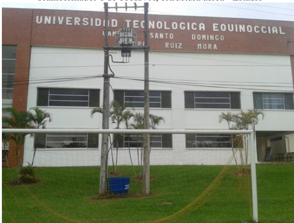
Figura N° 3.14 Transformador 1 de 100KVA, estructura aérea - Estadio
