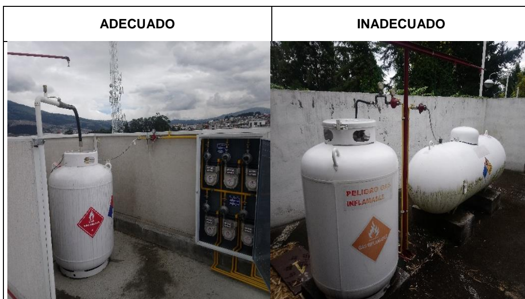
Figura 12.- Valoración de las Instalaciones Centralizadas
