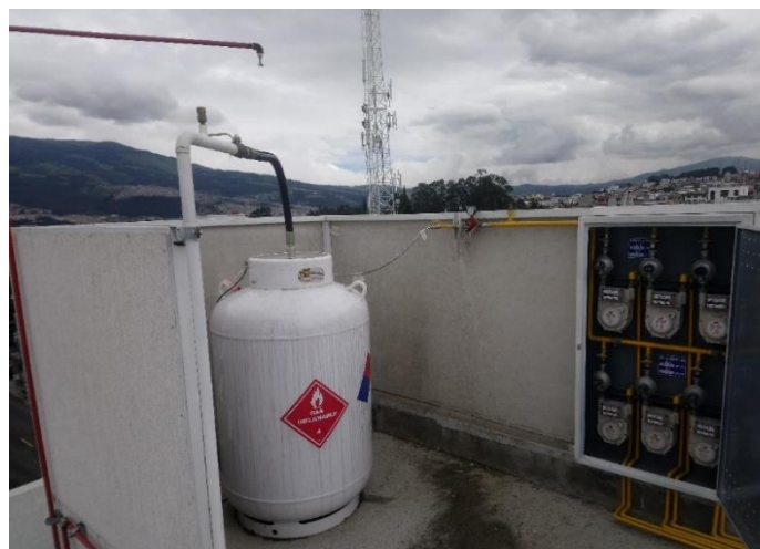
Figura 10.- Instalaciones Centralizadas de GLP
