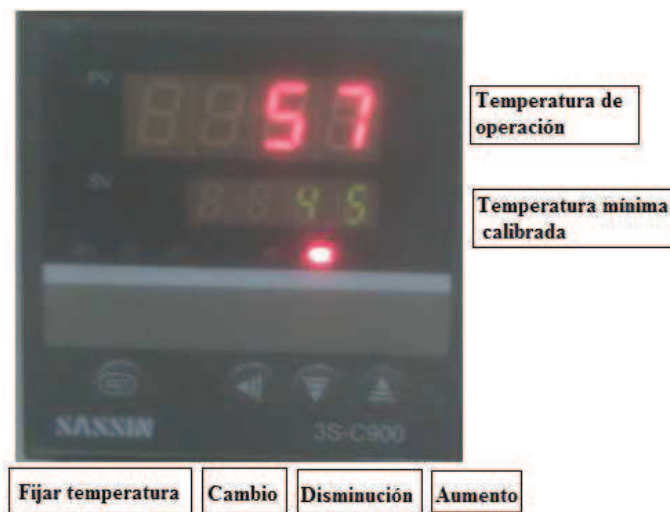
Figura: 6-10 Controlador de temperatura
