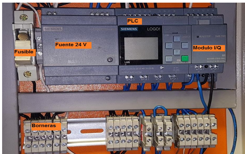
Figura 18. Tablero de control interno
