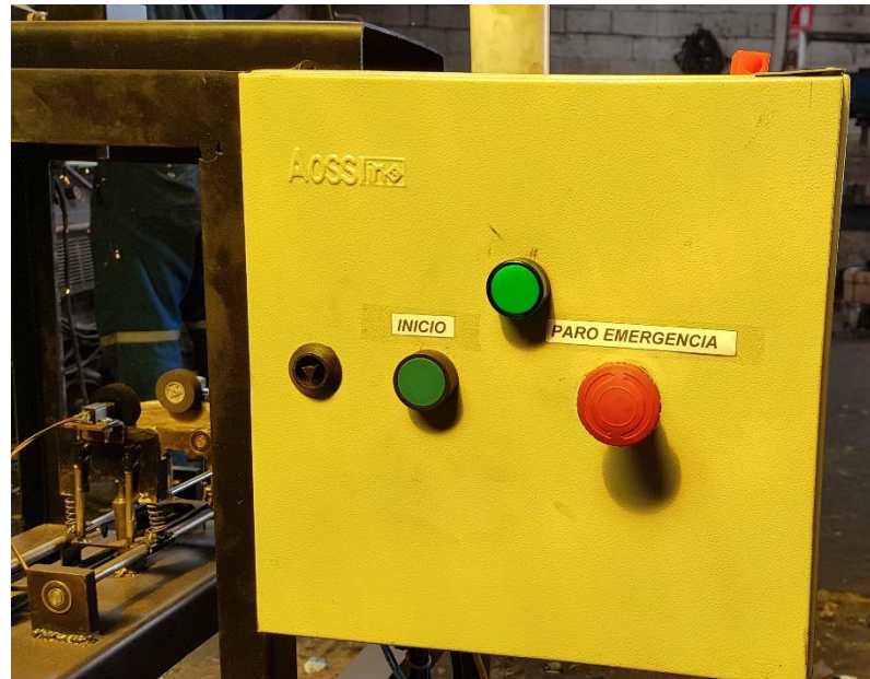
Figura 17. Tablero de control
