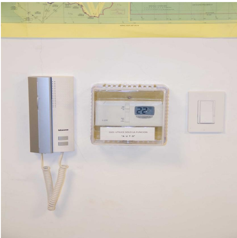
Fotografía 6. Regulador de temperatura del lugar donde laboran los CTAR, que mantiene el ambiente de trabajo a 22 grados centígrados. Elaborado por el autor
