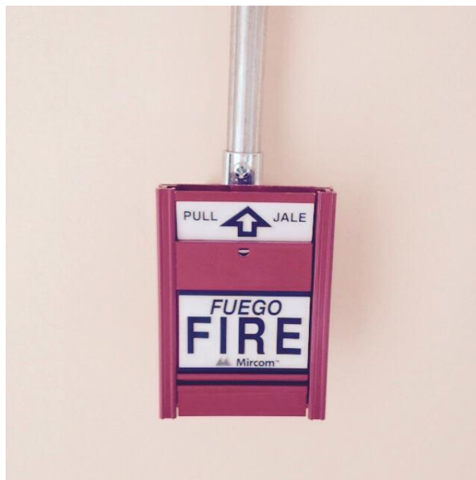
Figura 4.14 Estación manual MIRCOM instalada
