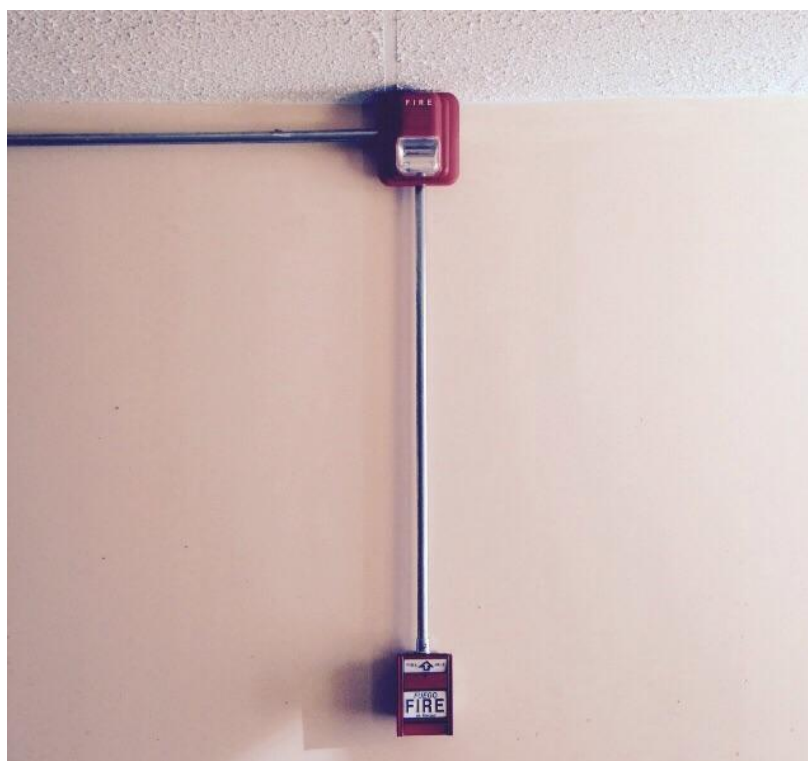
Figura 4.21 Instalación luz estroboscópica con sirena
