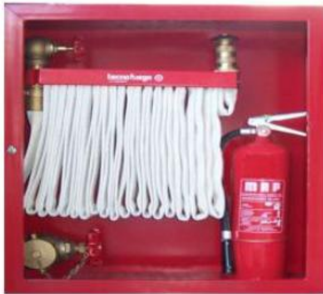
Figura 4.2 Gabinete de mangueras
