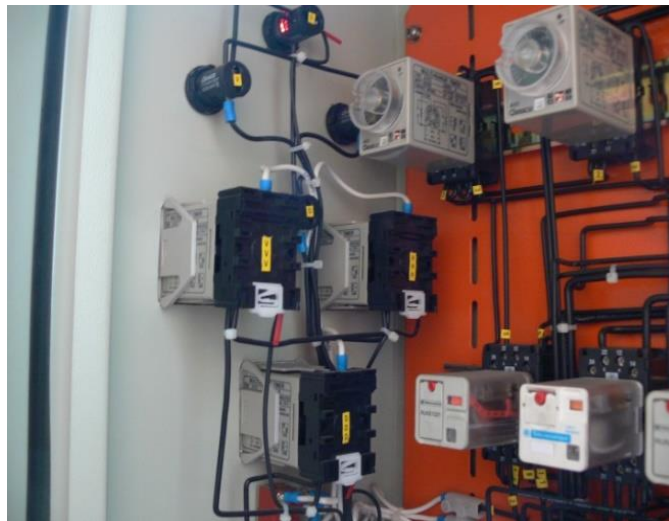
Figura 48. Cableado del tablero de control
