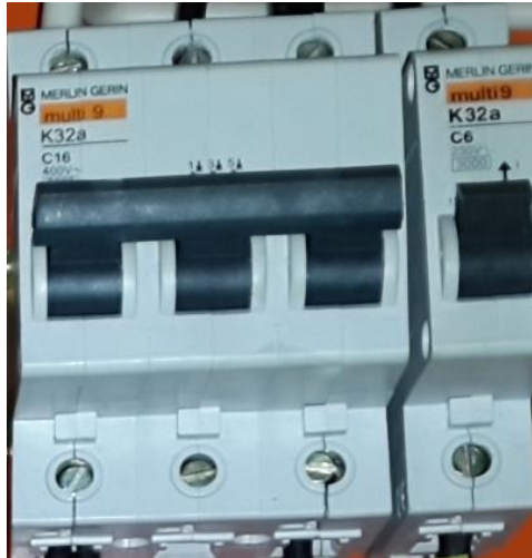
Figura 24. Disyuntor - K32A Multi 9 marca Merlin Gerin
