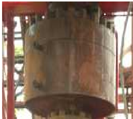
FIGURA 52: Tanque de Lodos.
