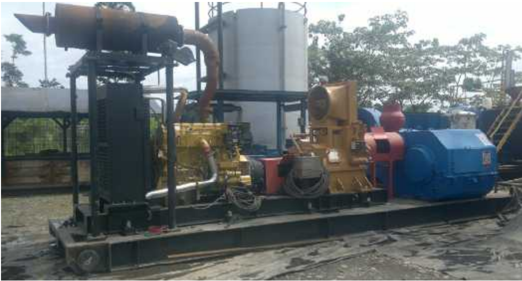
FIGURA 47: Bomba de Lodos
