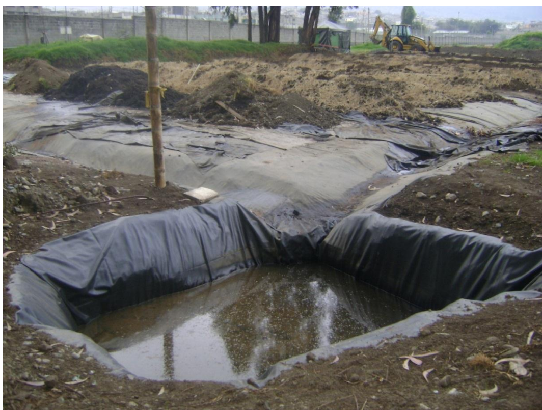
Figura 2. Plataformas de tratamiento biológico
