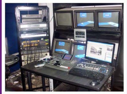
Instalaciones de Hoy TV Control de TV
