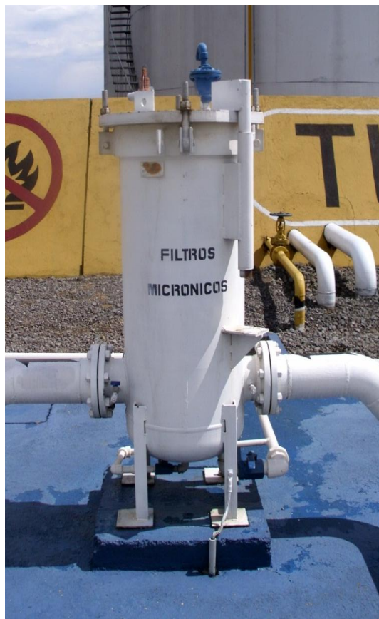
Figura 10: Filtro micronico de la Planta de Jet del Terminal Beaterio
