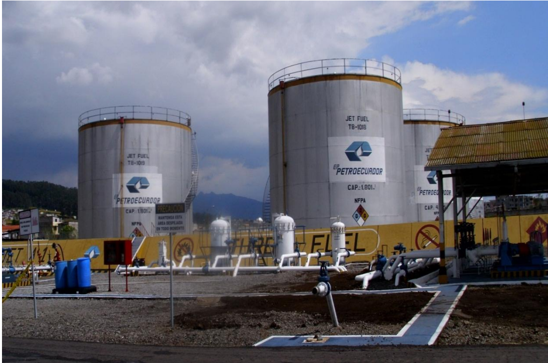
Figura 8: Disposición de Tanques de almacenamiento en la planta de Jet del terminal de productos limpios Beaterio
