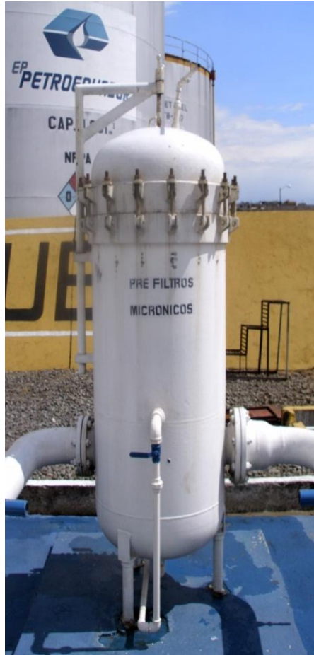
Figura 13: Prefiltro micronico para tratamiento del Jet Fuel del terminal Beaterio
