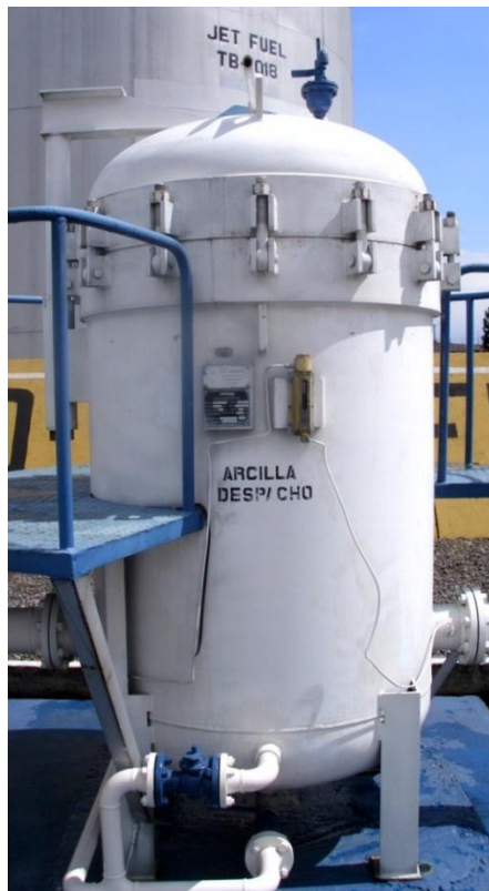
Figura 12: Filtro de arcilla para despacho de la planta de Jet del Beaterio
