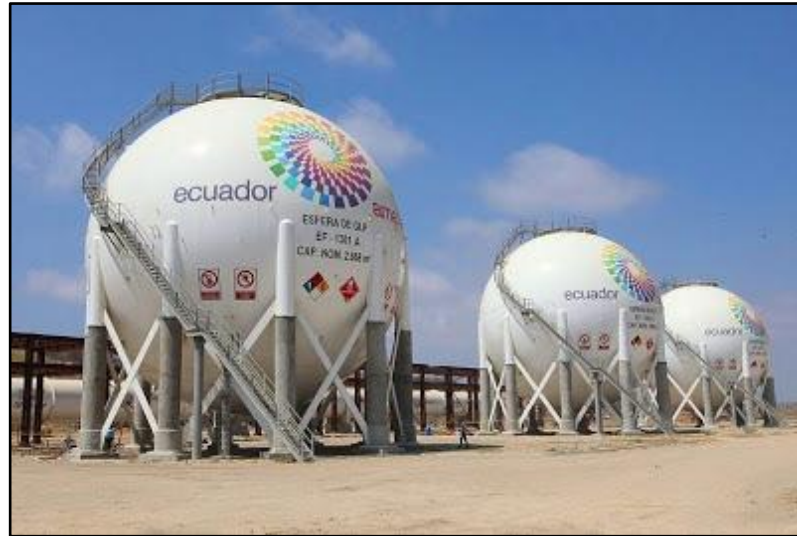
Figura 2.4. Tanques Esféricos para Almacenamiento de GLP. Fuente. (EP-PETROECUADOR, 2014)
