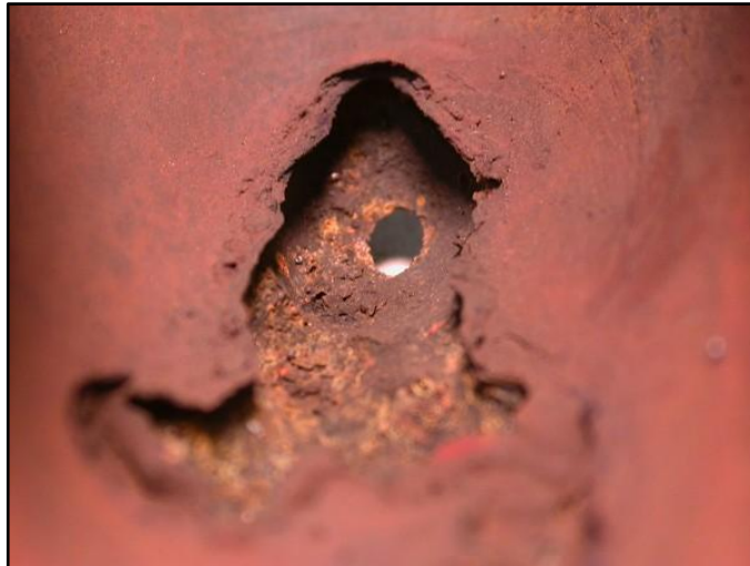
Figura 2.22. Corrosión Generalizada en el Metal. Fuente. (www.steelconstruction.info, 2014)
