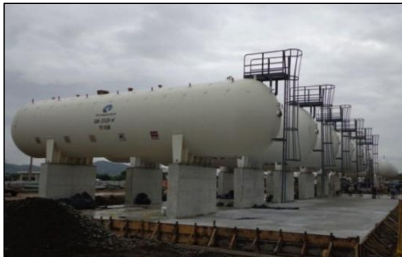
Figura 2.1. Tanques Horizontales, Proceso de Licuefacción de GLP. Fuente. (EP-PETROECUADOR, 2014)
