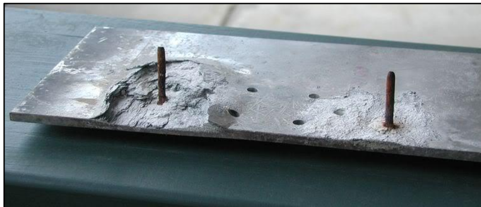
Figura 2.23. Corrosión Galvánica en Piezas Metálicas. Fuente. (www.steelconstruction.info, 2014)
