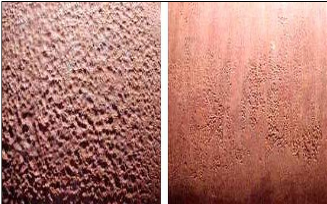
Figura 2.21. Corrosión Generalizada en el Metal. Fuente. (www.steelconstruction.info, 2014)
