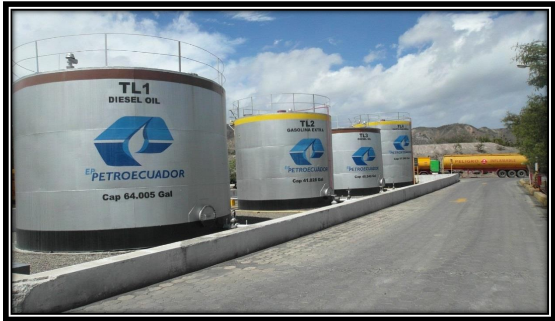
Figura 5. Tanques de Almacenamiento del depósito la Toma Fuente: Gómez Edison
