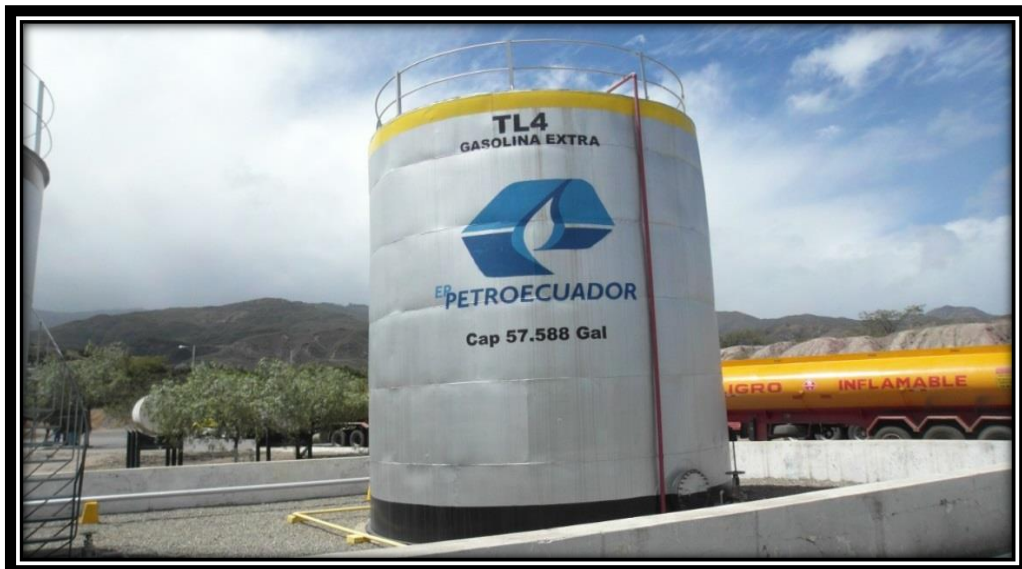
Figura 17. Tanque vertical de techo fijo
