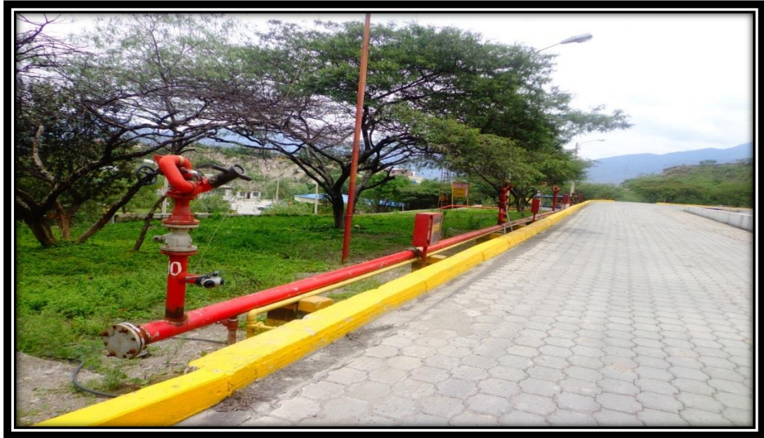
Figura 12. Línea de agua contra incendios ubicada en la parte delantera de los tanques de almacenamiento
