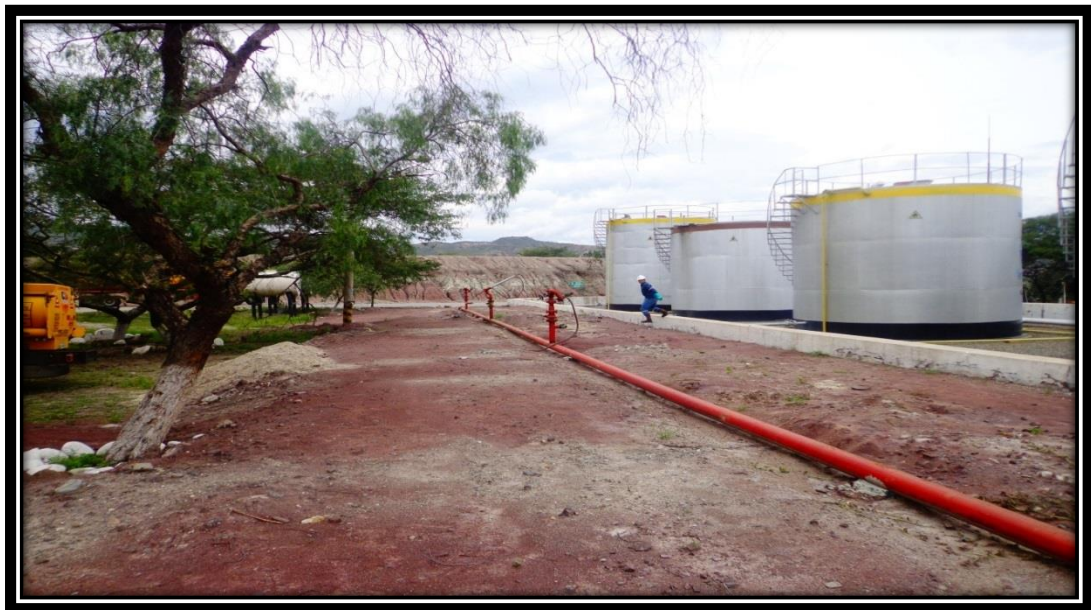
Figura 13. Línea de agua contra incendios ubicada en la parte trasera de los tanques de almacenamiento
