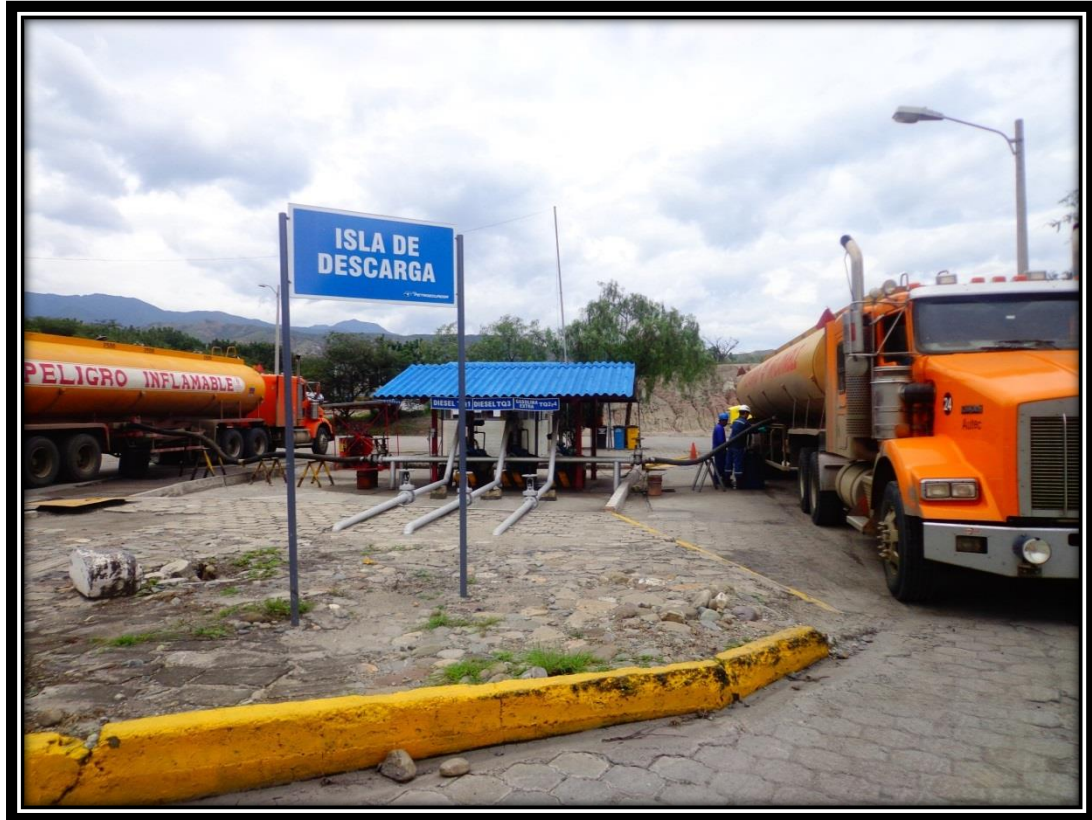
Figura 8. Área de recepción del producto Fuente: Gómez Edison
