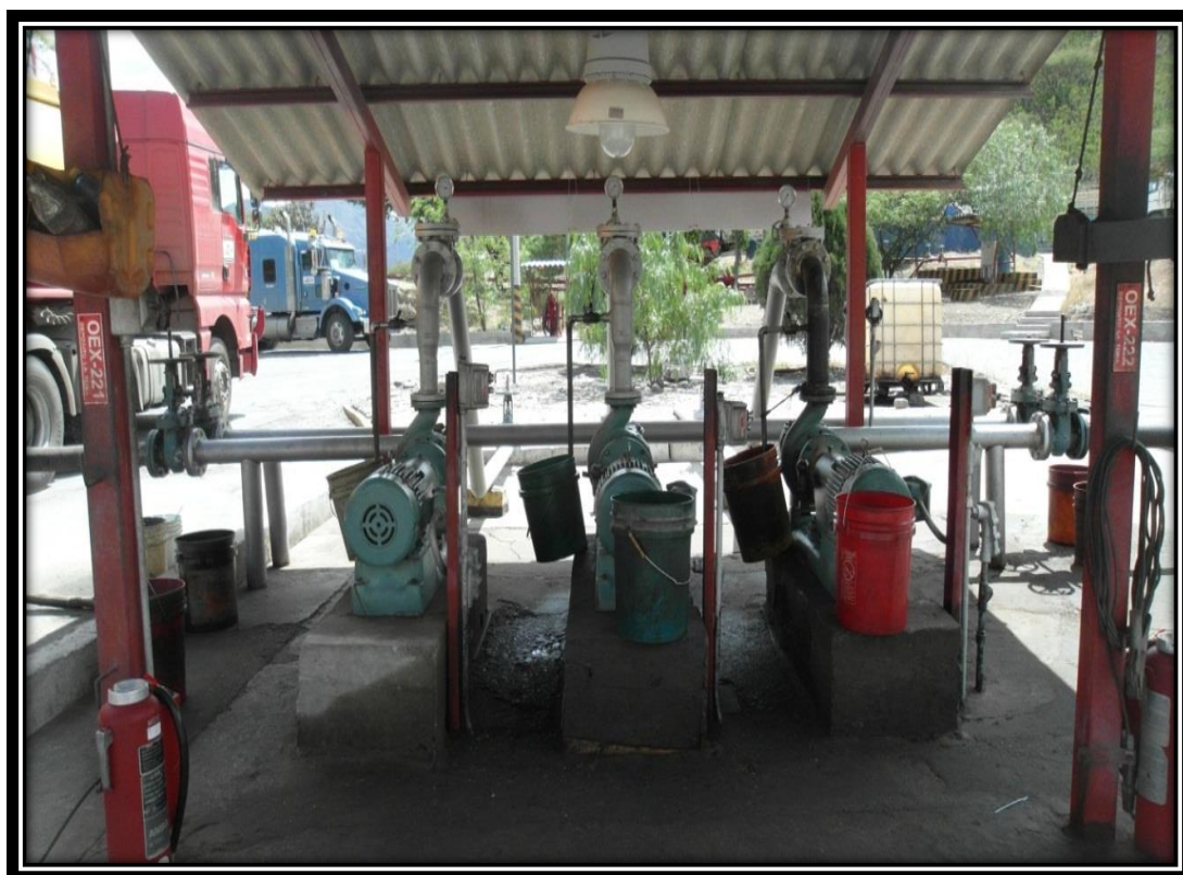
Figura 7. Bombas utilizadas para la recepción del producto Fuente: Gómez Edison
