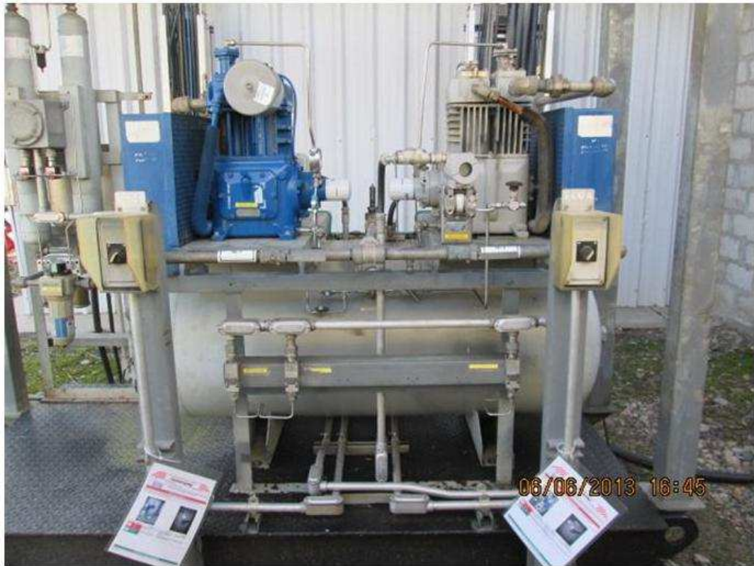
Figura 2.40. Compresores de Aire
