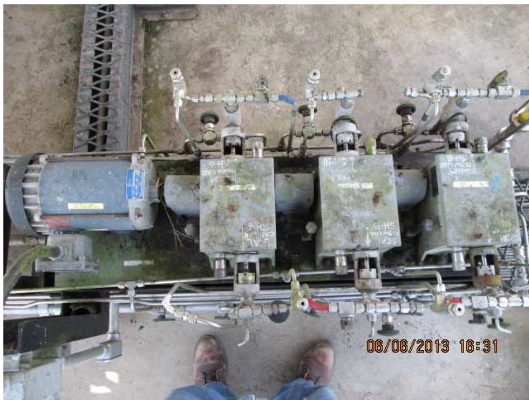
Figura 2.16. Bombas de Químicos
