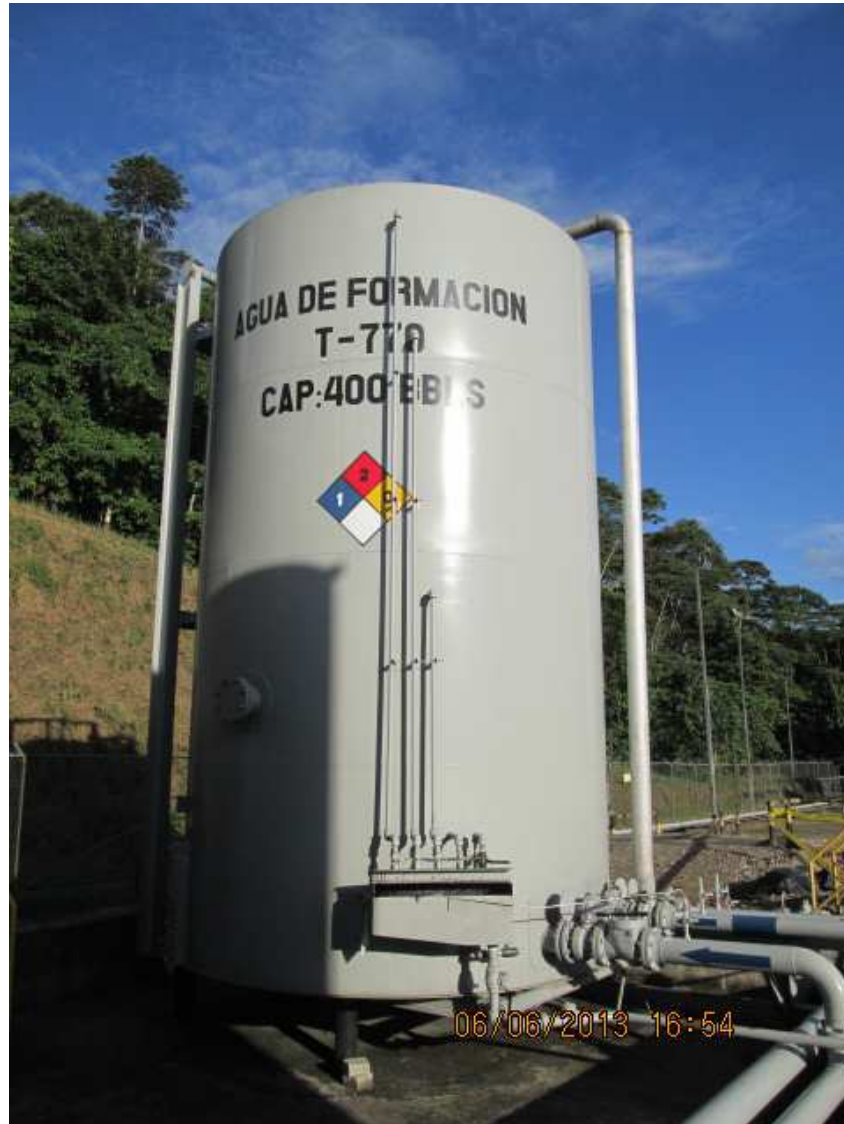
Figura 2.31. Tanque de Almacenamiento de Agua
