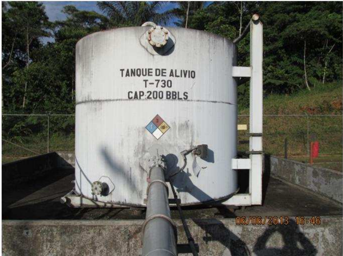
Figura 2.17. Tanque de Alivio
