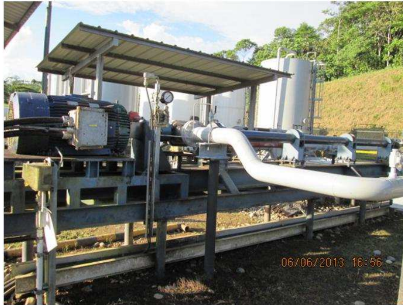
Figura 2.33. Bomba de Inyección de Agua
