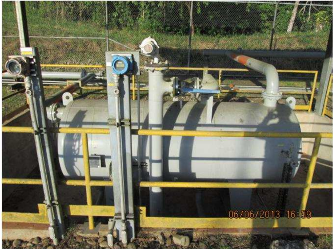
Figura 2.37. Flare Knock Out Drum
