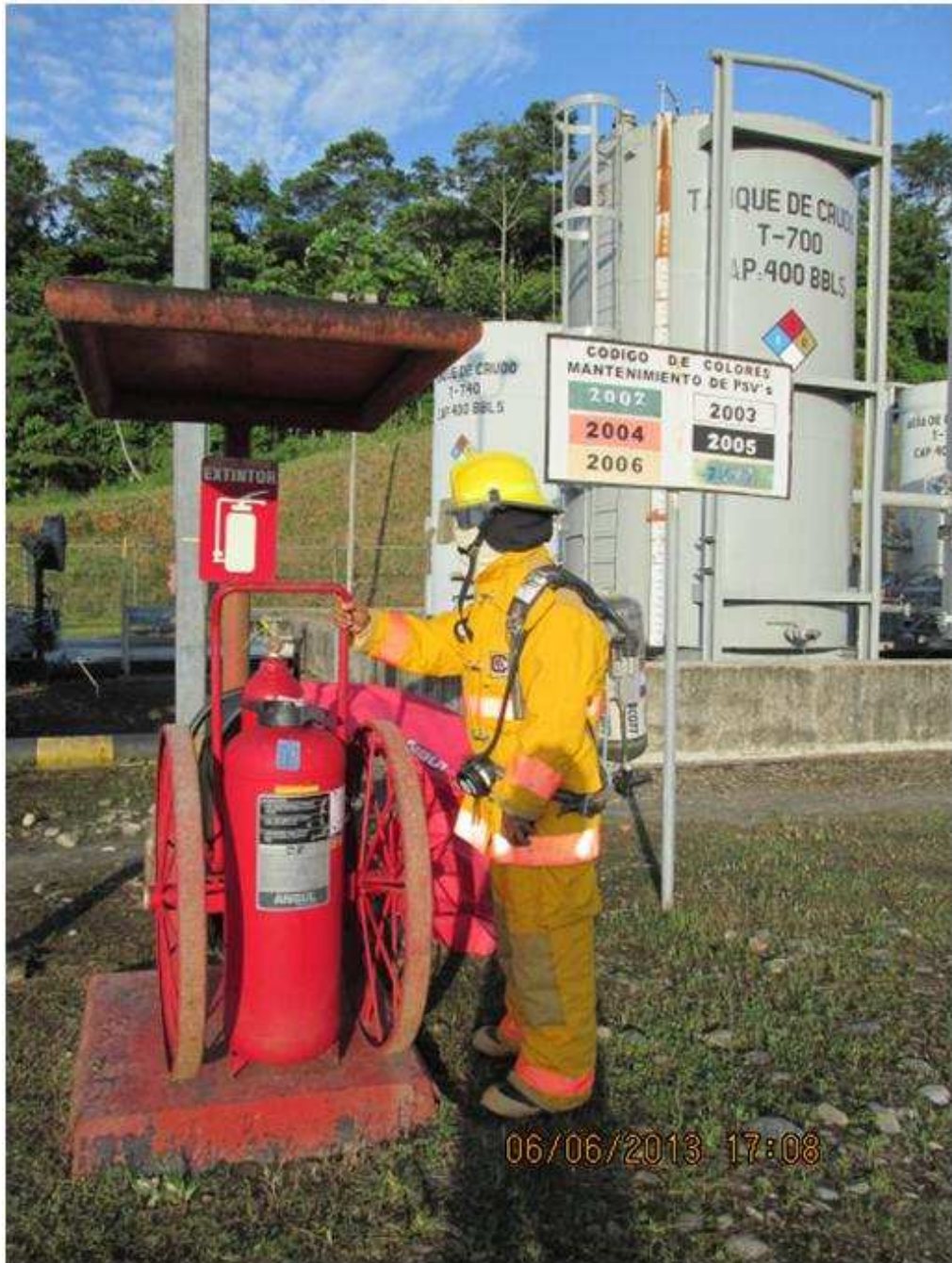
Figura 2.50. Operador equipado y listo para respuesta a emergencia
