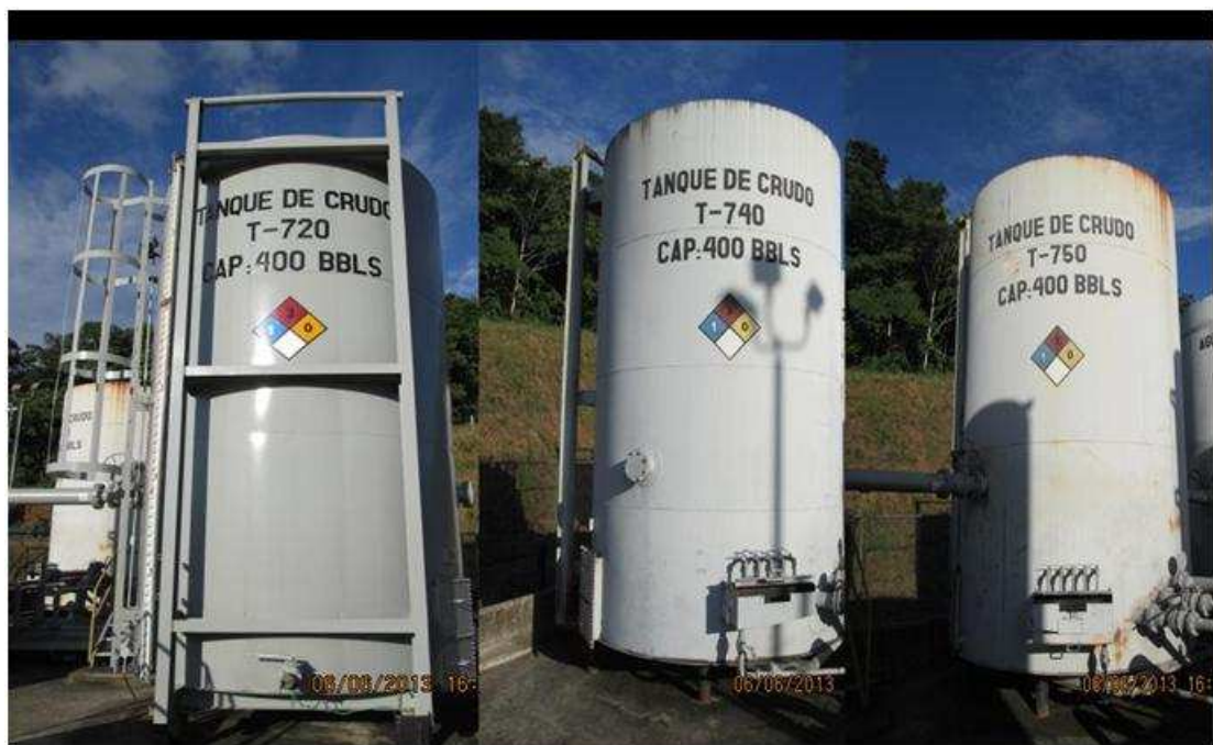
Figura 2.26. Tanques de Crudo
