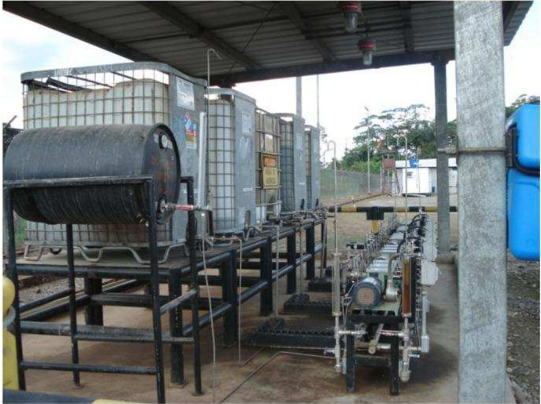
Figura 2.15. Skid de Químicos
