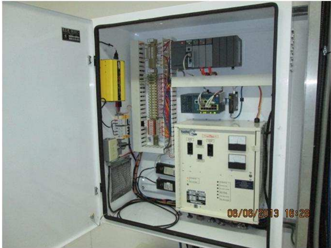
Figura 2.43. Anaquel del PLC y UPS.
