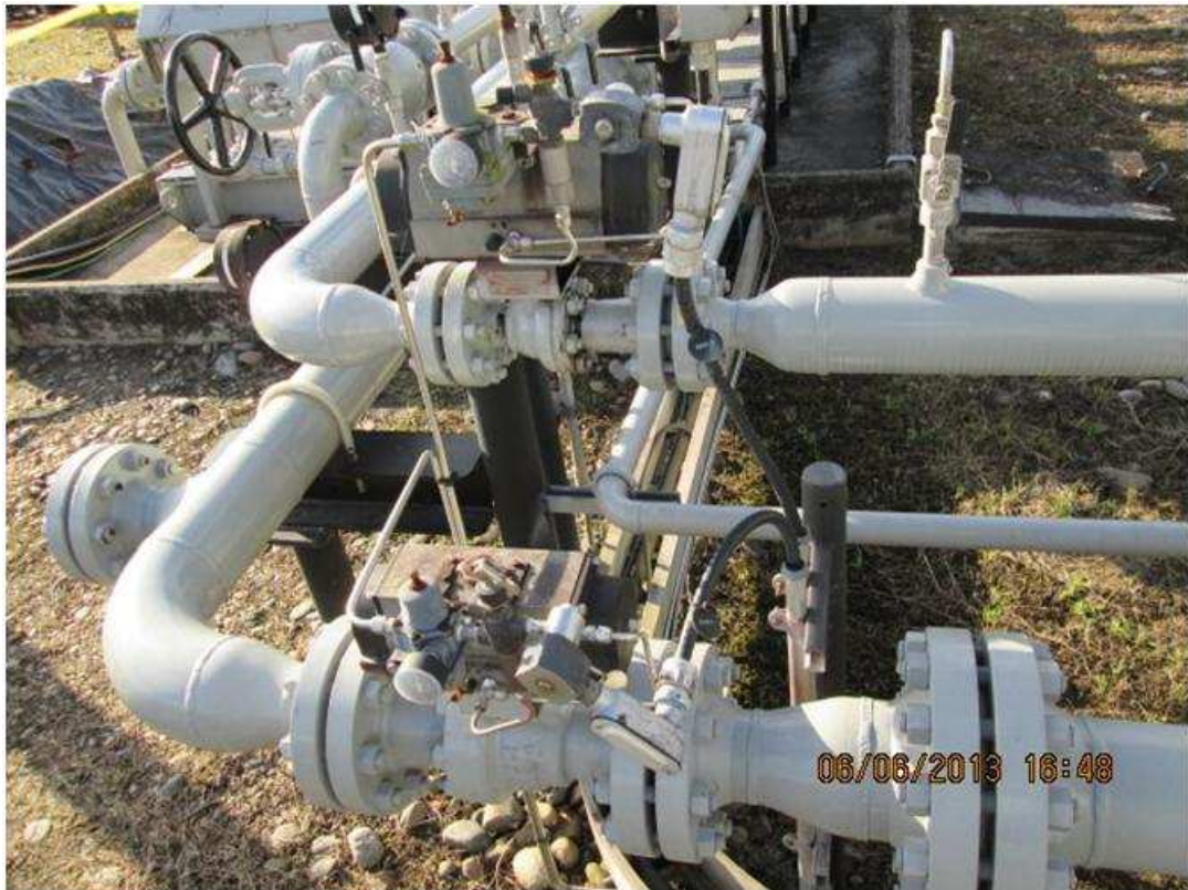
Figura 2.13. Válvulas ESDV-1 y ESDV-2
