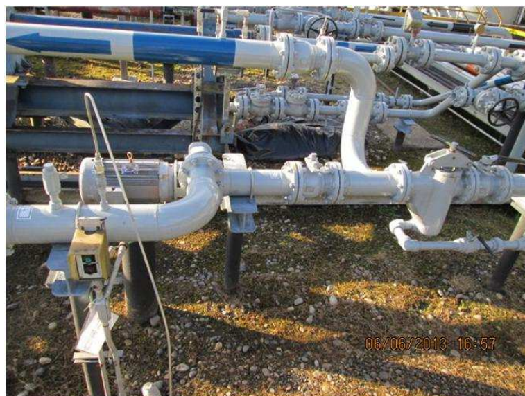
Figura 2.32. Bomba Booster de Agua
