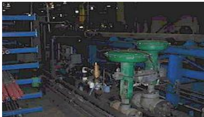
Figura 55: Sistema de válvulas para ensayos
