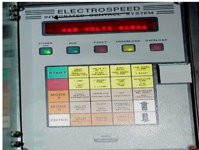
Figura 66: Display 3 controlador del banco de ensayos
