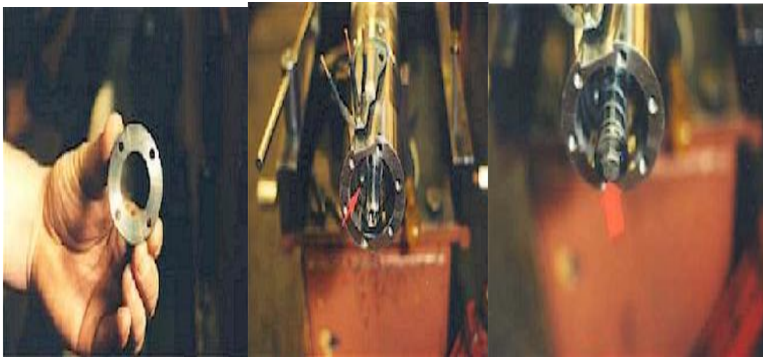
Figura 118: Seguros de los bearings instalados en el cabezal del motor
