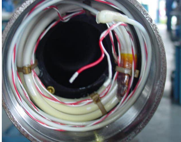
Figura 73: Conexión de RTD en el bobinado el estator
