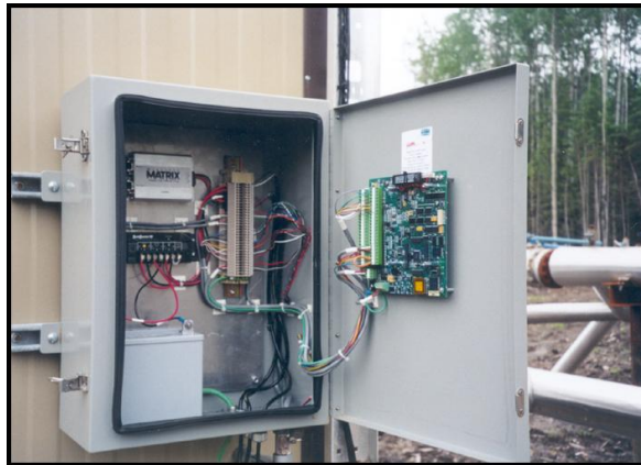
FIGURA 2.8 SITE COMUNICACION BOX.
