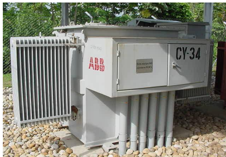
FIGURA 2.4 TRANSFORMADORES DE VOLTAJE
