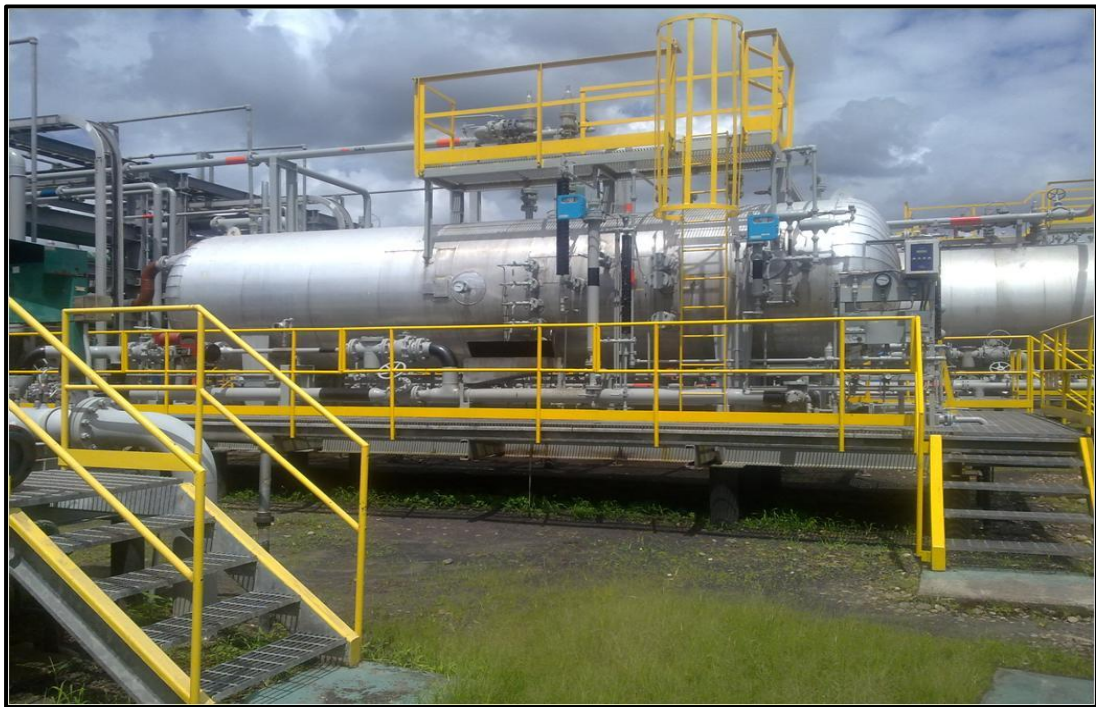
Figura 26. Separador de prueba convencional
