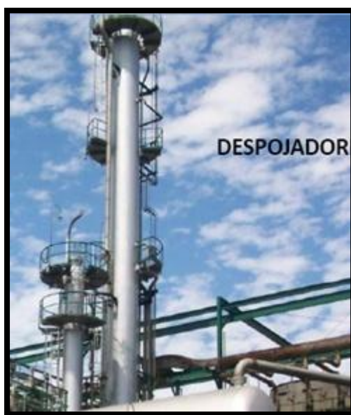
Figura 2.14 Despojador usado en la REE para el proceso (HDS).
