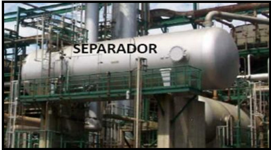
Figura.2.10 Separador usado en la Refinería Estatal de Esmeraldas.
