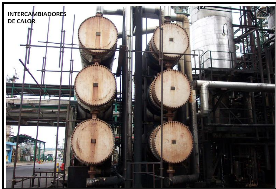
figura.2.17 Intercambiadores de calor usados en la REE
