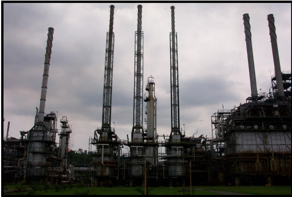
Figura. 2.12 Hornos de la planta hidrodesulfuradora (HDS) en la REE.
