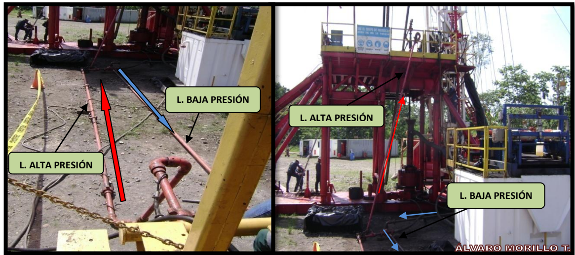
FIGURA 13: LÍNEAS INDIVIDUALES DE FLUIDO MOTRÍZ DE LOS POZOS
