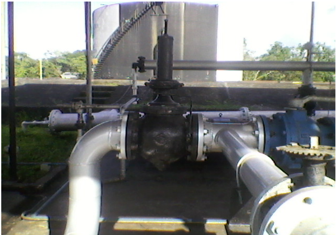
FIGURA N° 16 VÁLVULA DE CONTRAPRESIÓN
