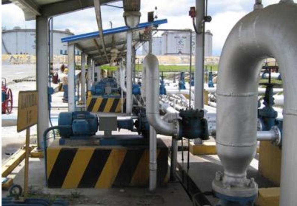
Figura 2: Área de Bombas
