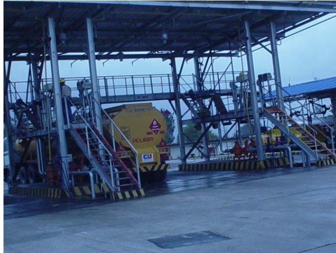
Figura 4: Isla de carga de combustible
