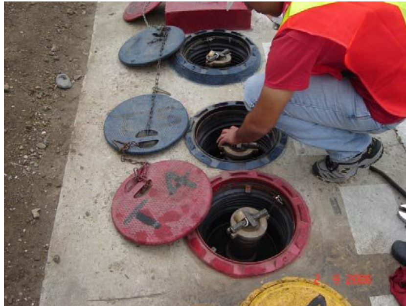
Figura 2: Puntos de descarga en las Estaciones de Servicio
