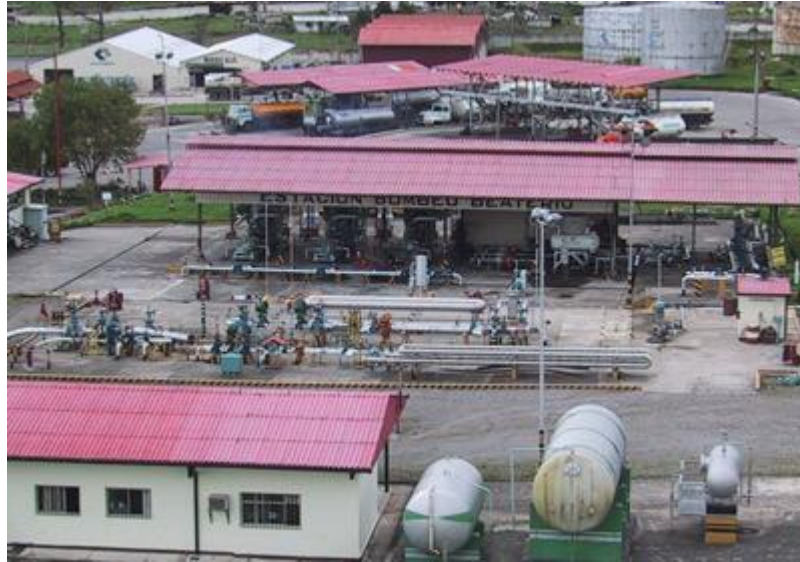
Figura 5: Estación de Bombeo
