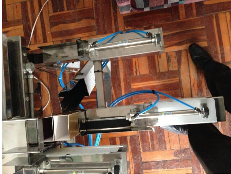
Figura 4.65. Cilindros neumáticos instalados (Loaiza, 2014)
