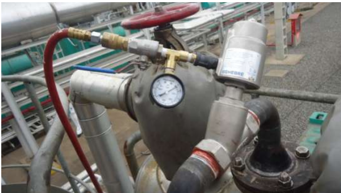
FIGURA 43. Fotografía de la electroválvula implementada
