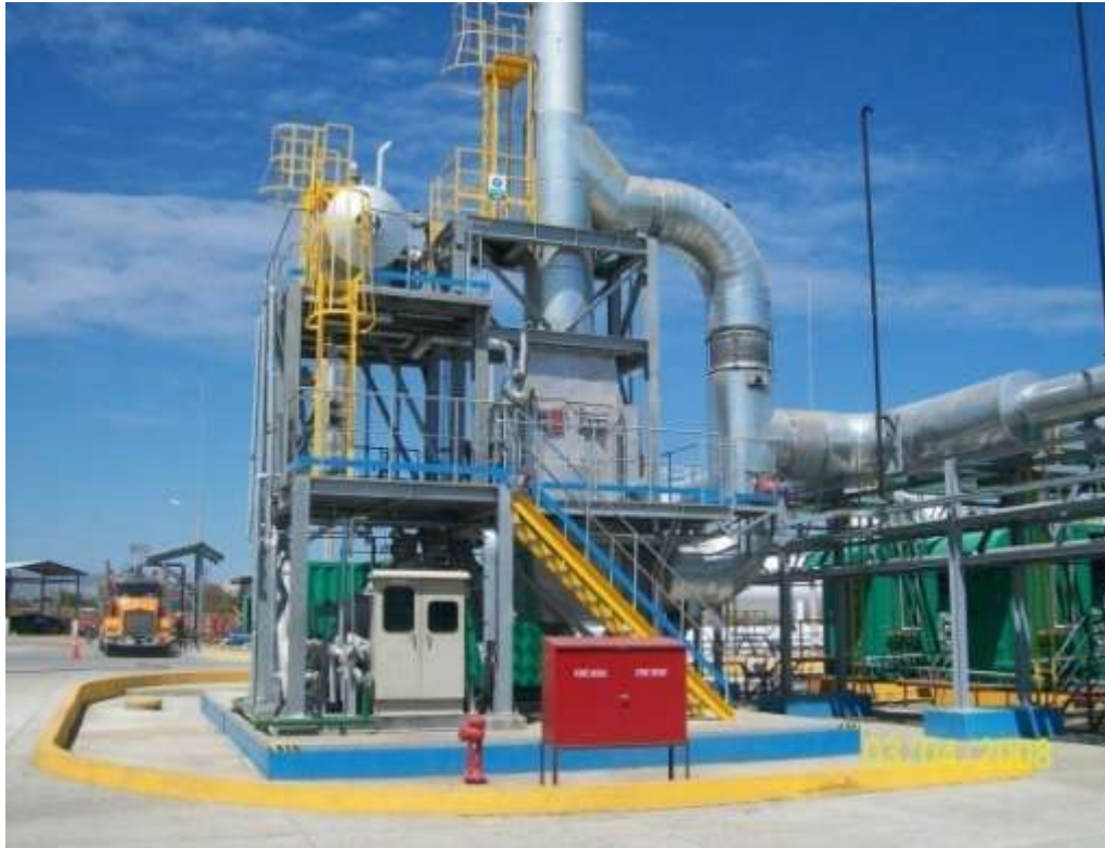
FIGURA6. Fotografía de la caldera
