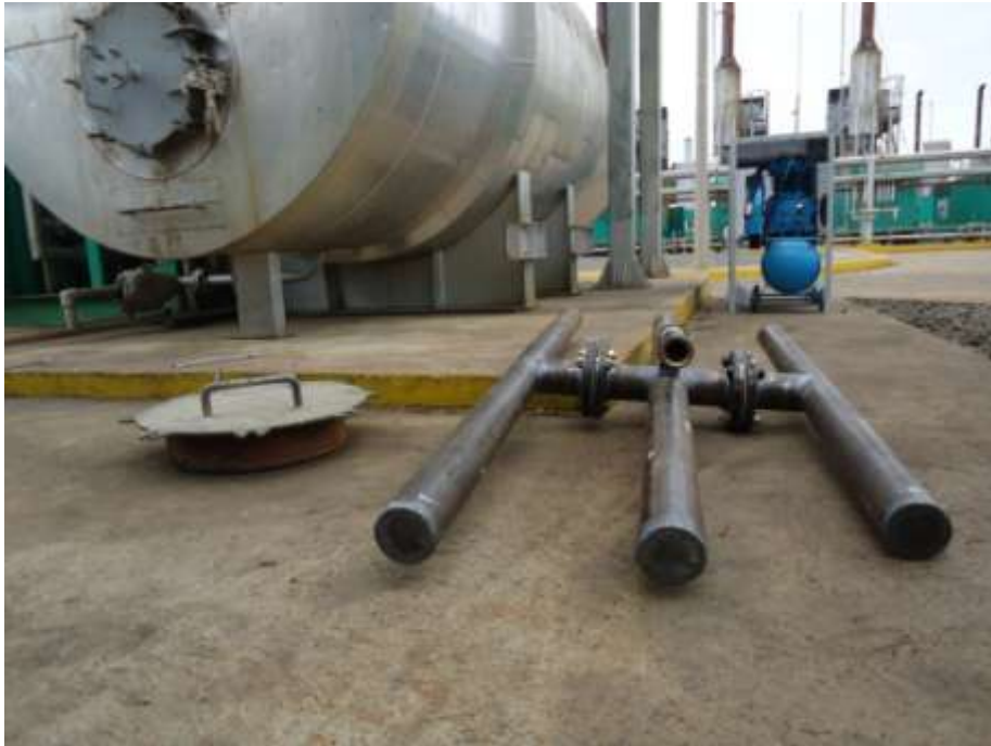
FIGURA22. Fotografía de la tubería completa
