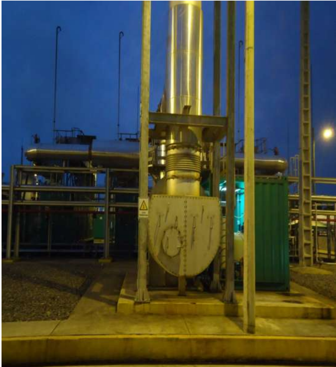
FIGURA26. Fotografía de la caldera sin implementación
