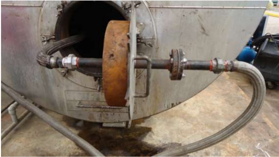
FIGURA20. Fotografía de la tubería adaptada para el soplador
