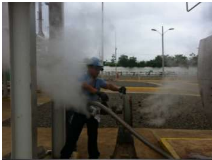
FIGURA17. Fotografía soplado de caldera.
