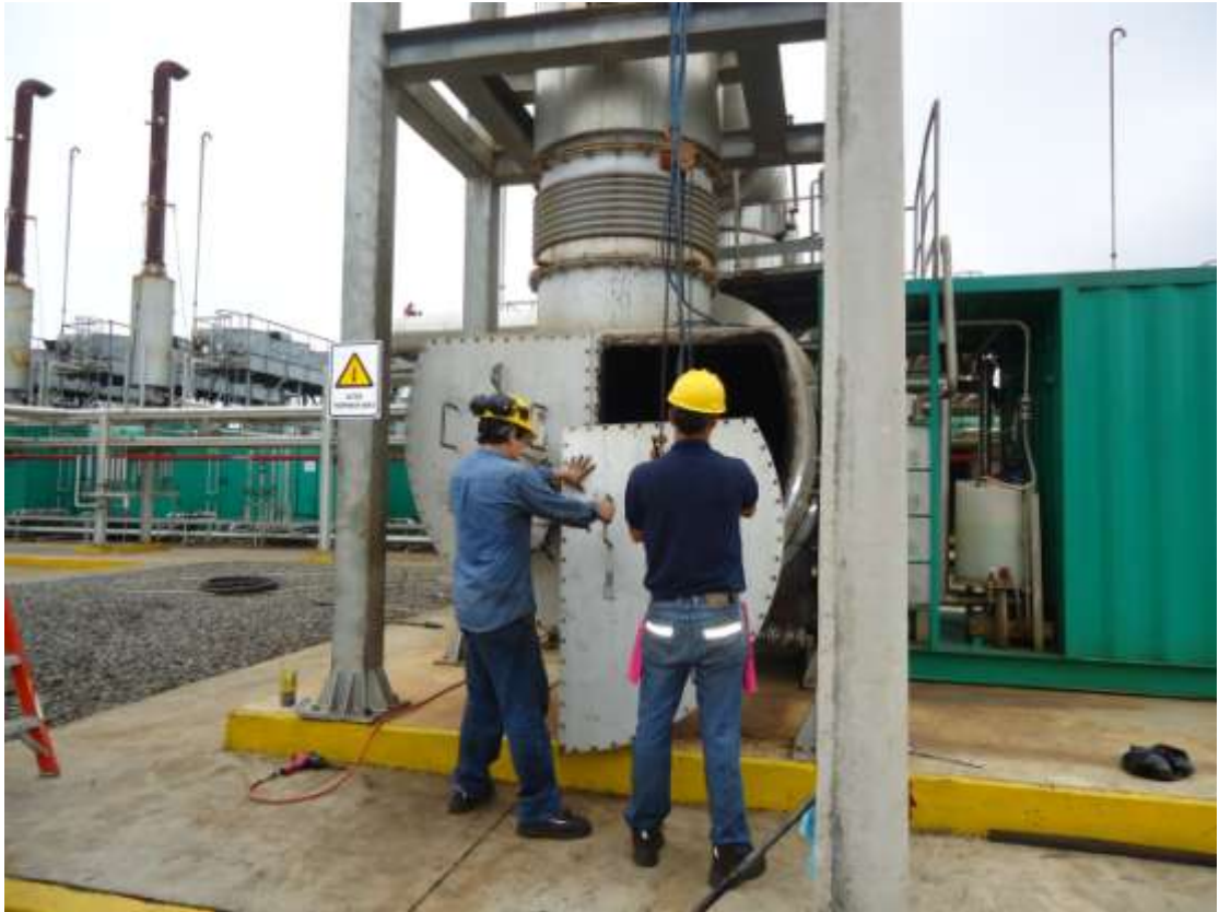
FIGURA27. Fotografía del desmontado de la tapa
