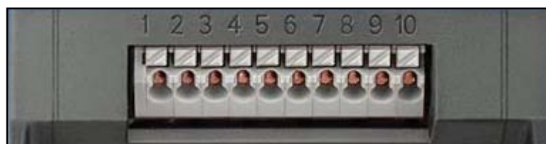
Figura 26: Bornes del Variador de Frecuencia (SIEMENS, 2004)
