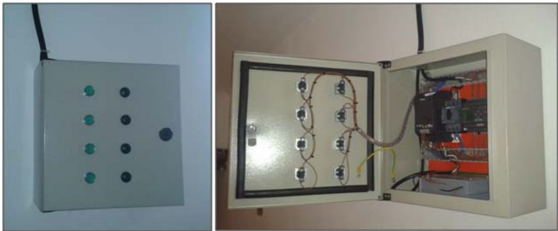
Figura 68: Ubicación del Panel de Control
