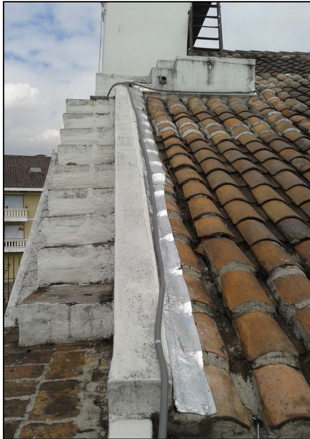
Figura 67: Recorrido del cableado (tejado)
