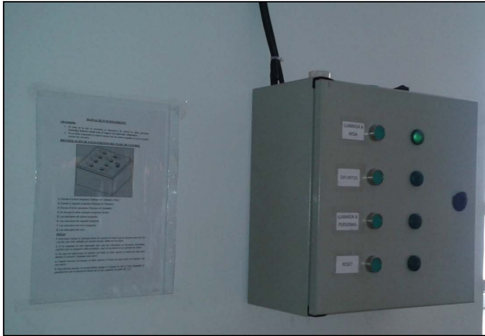
Figura 70: Resultado de la Implementación de Componentes Eléctricos
