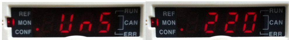
Figura 81. Ingresar la tensión nominal del motor.
