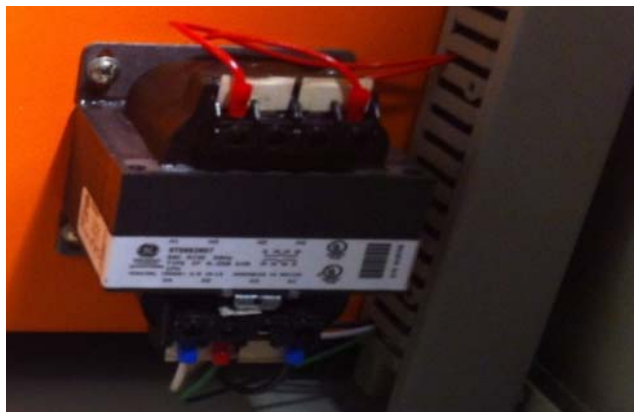
Figura 72. Transformador 240V-120V zona 9.
