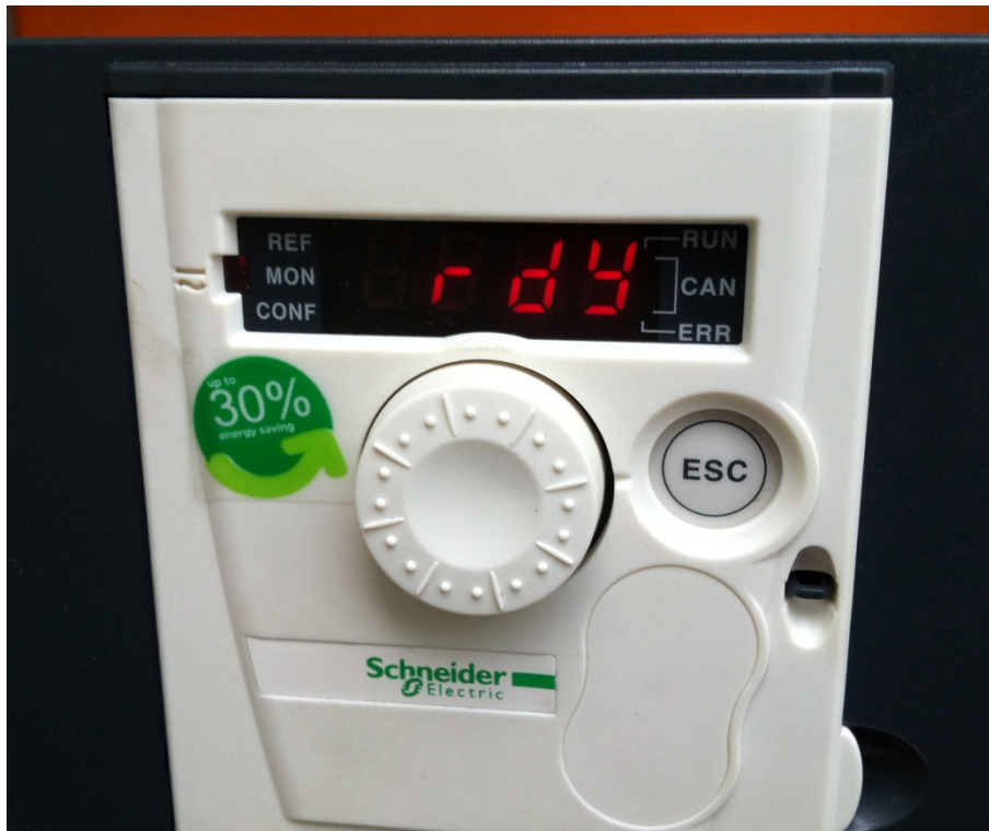
Figura 78. Variador ATV312HU75M3 energizado previo a configuración.
