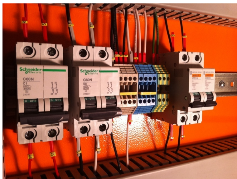
Figura 68. Protecciones de transformador, borneras de 120V, fuente y PLC zona 5.
