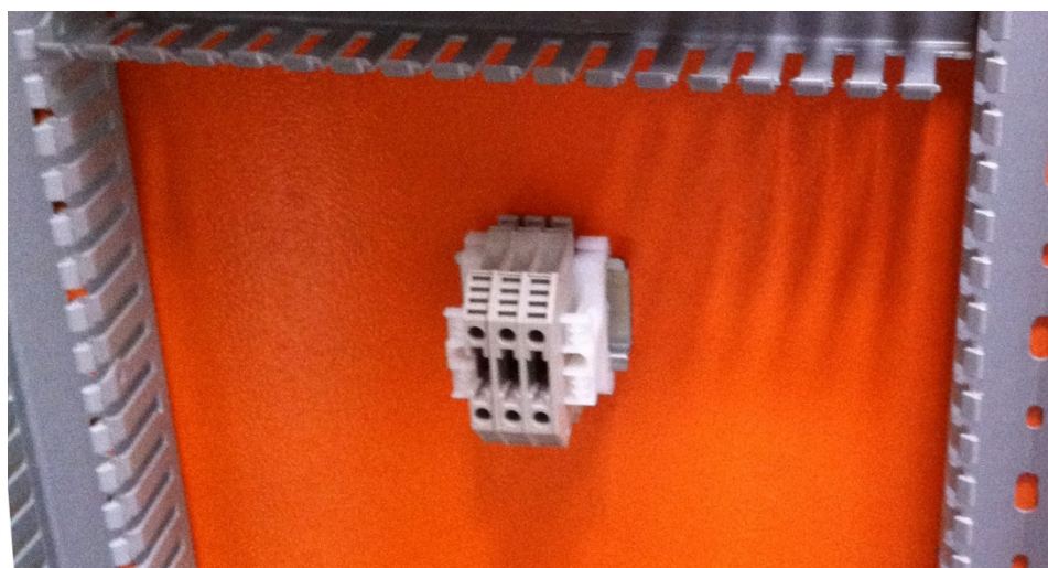
Figura 57. Borneras del motor zona 4.
