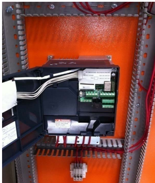
Figura 66. Variador de velocidad y bornera a motor zona 3 y zona4.
