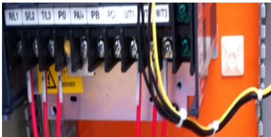
Figura 67. Entradas y salidas de potencia del variador de velocidad.
