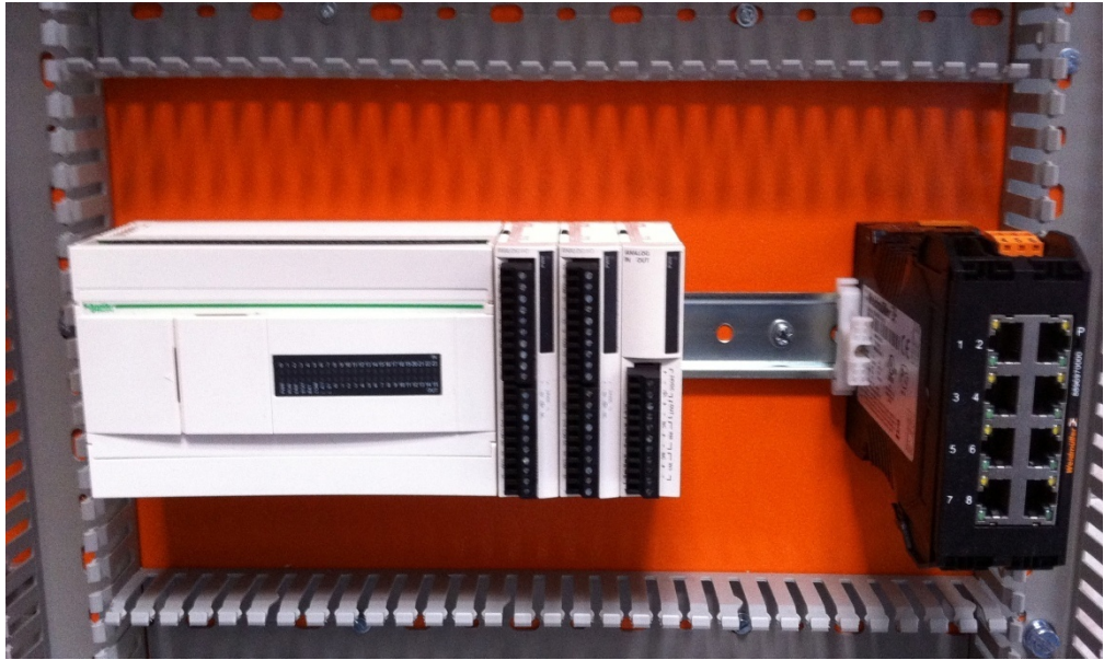
Figura 60. PLC, módulos analógicos y switch Ethernet zona 7.
