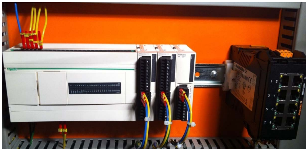
Figura 70. PLC, módulos analógicos, switch Ethernet zona 7
