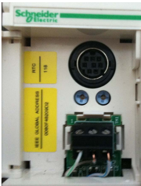
Figura 115. PLC con tarjeta TWDNAC485T, conectado al variador.
