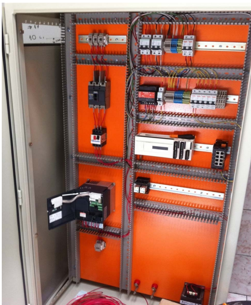
Figura 73. Armario de fuerza y control cableado.
