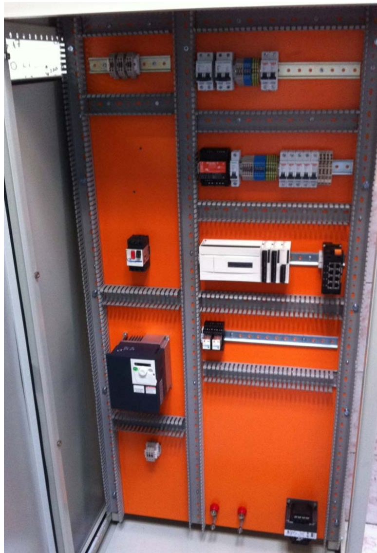
Figura 63. Montaje completo de equipos armario fuerza y control.
