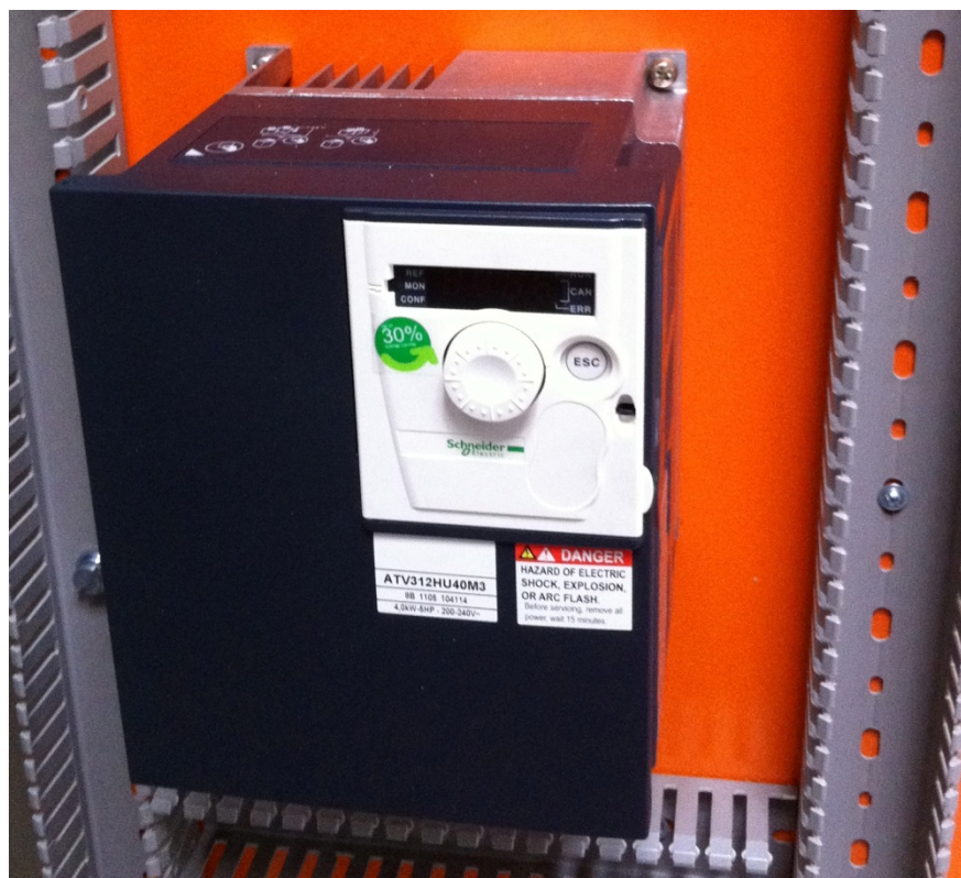
Figura 56. Variador de velocidad zona 3.
