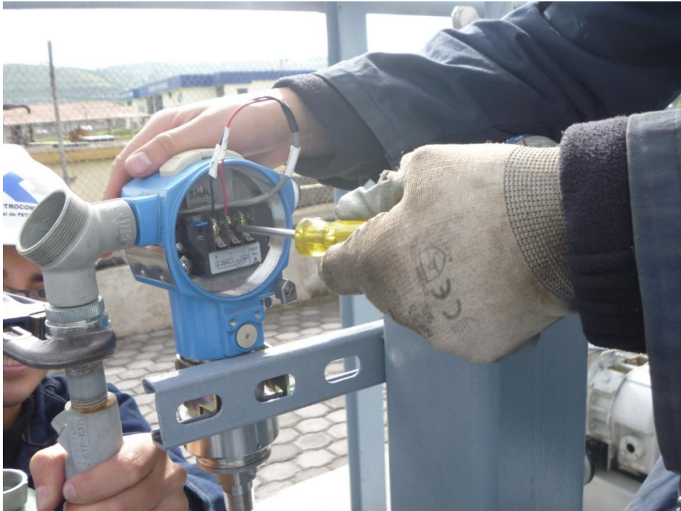
Figura N° 4. 3 Desmontaje del transmisor
