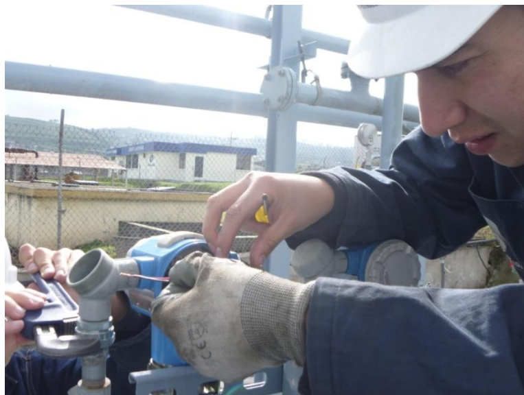
Figura N° 4. 10 Conexión del transmisor.
