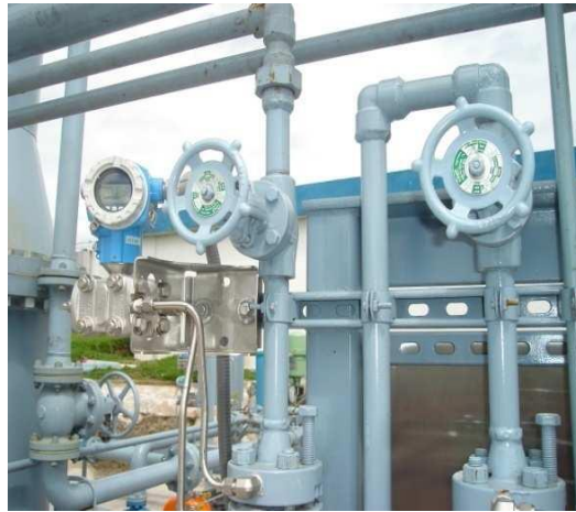
Figura N° 2. 34 Transmisor de Nivel
