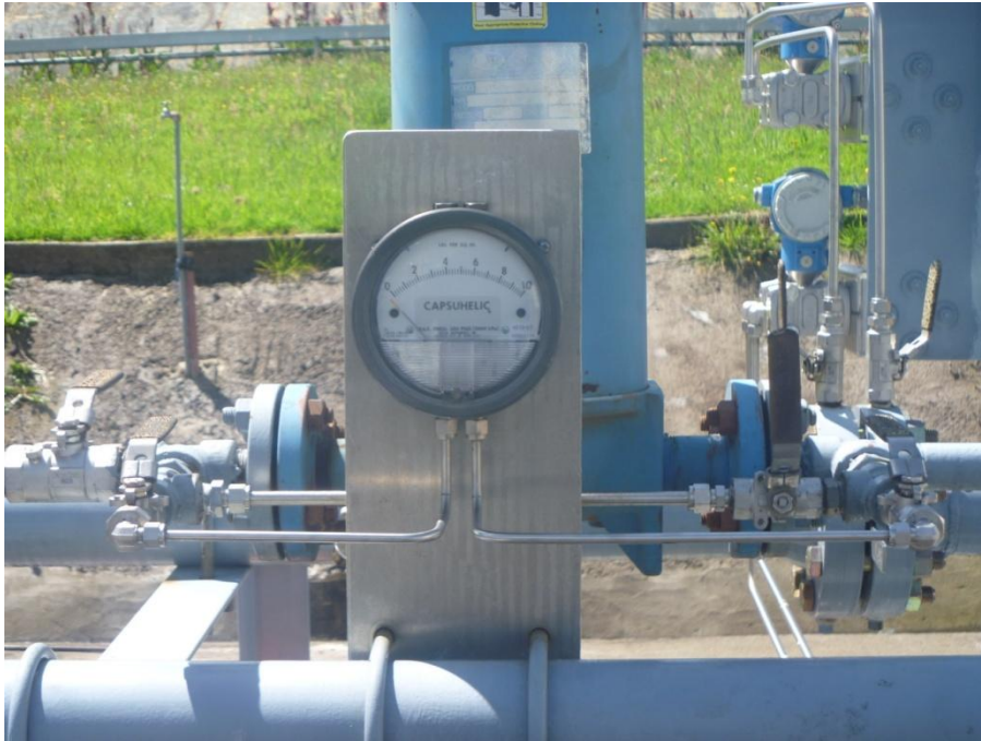
Figura N° 4. 25 Manómetros actuales de presión diferencial.
