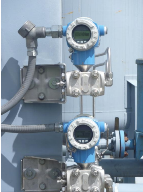
Figura N° 4. 23 Transmisores de presión diferencial.
