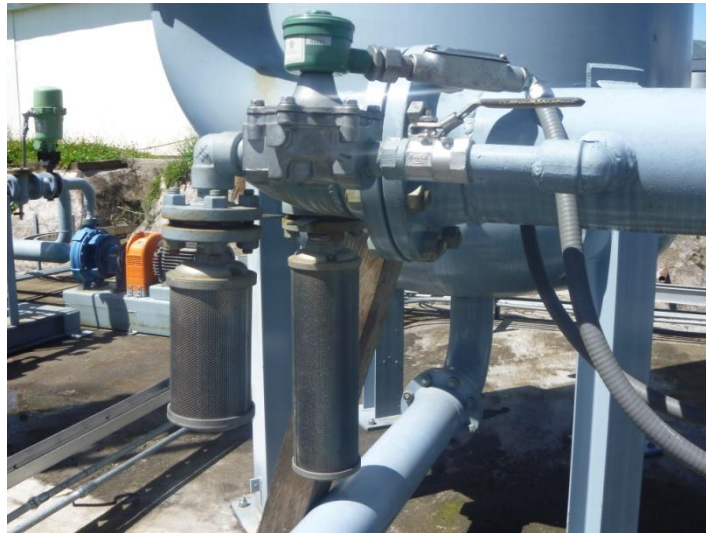
Figura N° 2. 28 Filtros de Aire
