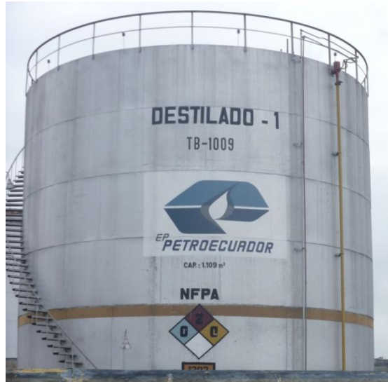
Figura N° 4. 22 Tanque Futuro del Sistema de recuperación de vapores.
