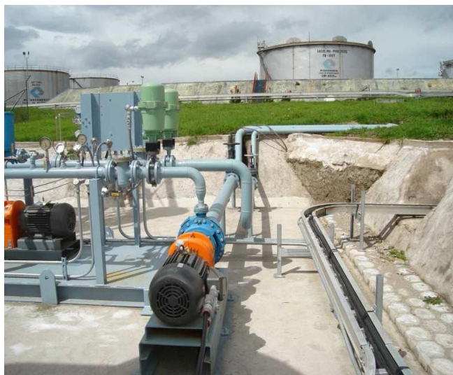
Figura N° 2. 32 Supply Pump P-201
