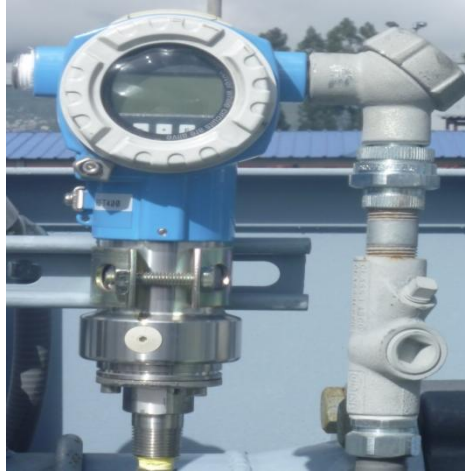
Figura N° 2. 5 Transmisor de presión Cerabar PMC71-TAC1H6RADAA
