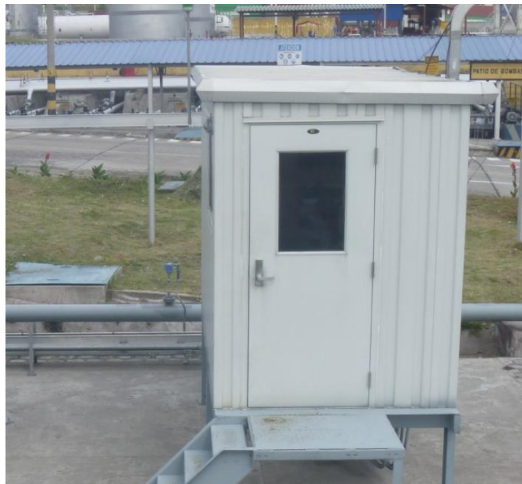
Anexo N° 6 Cabina de Control del Sistema de Recuperación de Vapores
