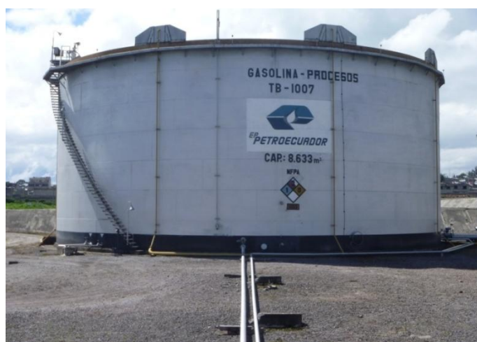
Figura N° 4. 21 Tanque actual del Sistema de recuperación de vapores.
