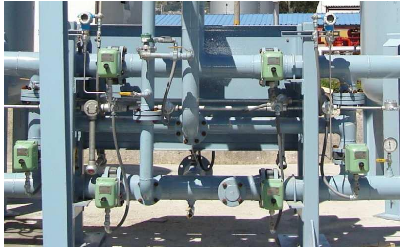
Figura N° 2. 23 Válvulas de Entrada
