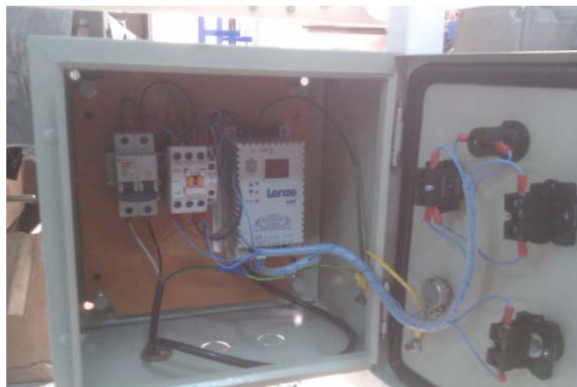
Figura N° 4. 15 Cableado de control de velocidad de la banda transportadora
