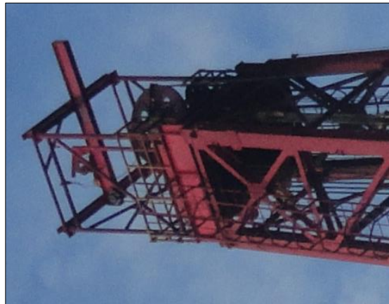
Figura 36. Arreglo de perfiles estructurales tipo cajón bajo el bloque corona de un mástil de perforación.
