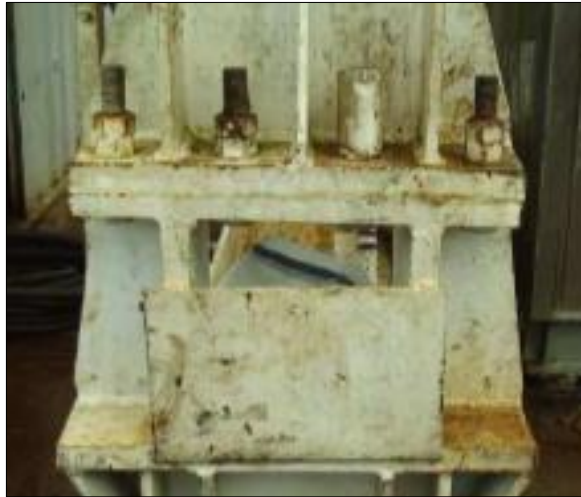
Figura 24. Pernos en soportes del mástil de perforación.
