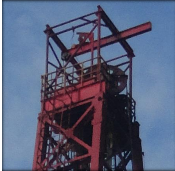
Figura 9. Bloque corona de un mástil de perforación.
