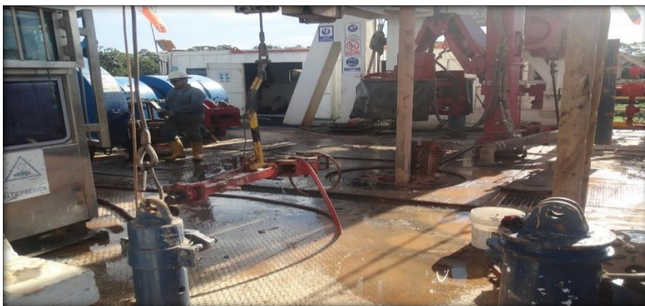
Figura 12. Piso o mesa del mástil de perforación.
