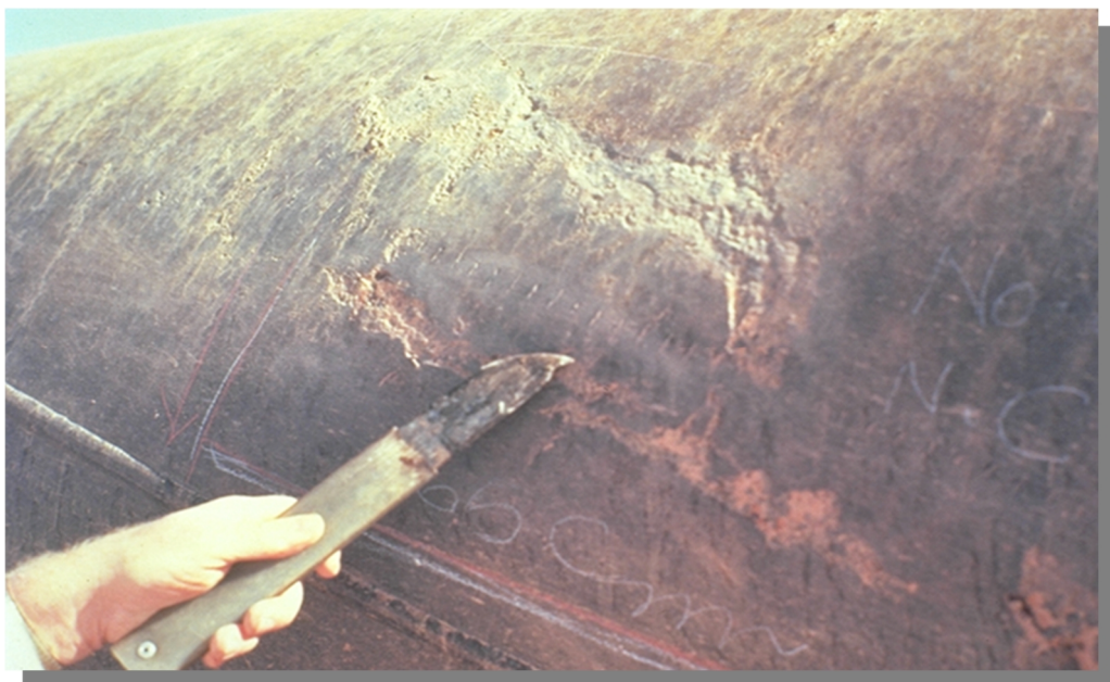
Figura 4. Picaduras en Ducto Enterrado
