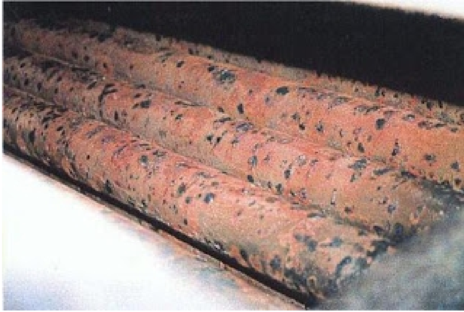
Figura 5. Corrosión por Picadura
