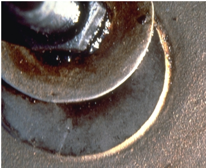
Figura 2. Corrosión General Fuente: (ARCH, 2011)
