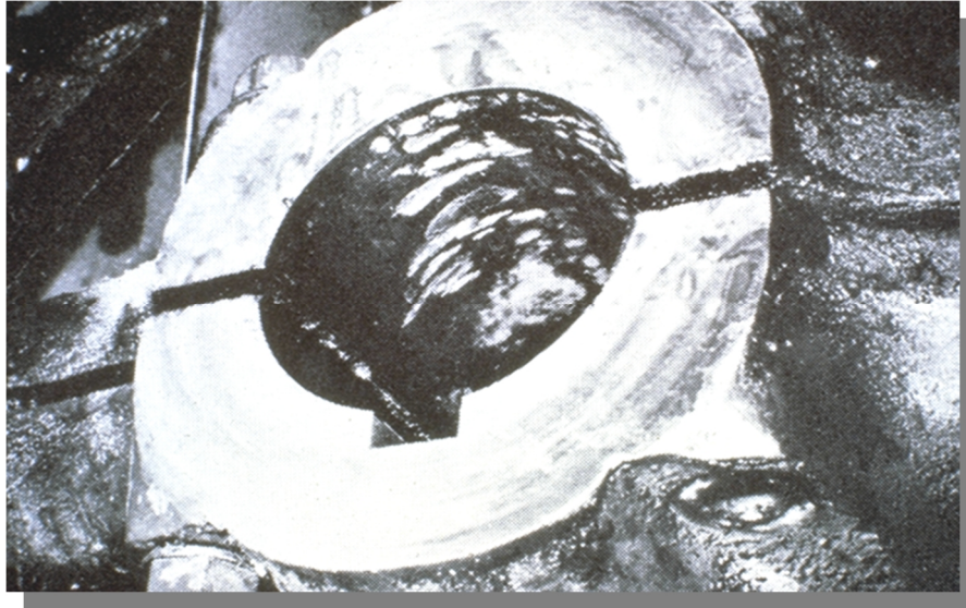
Figura 13. Corrosión por Rozamiento
