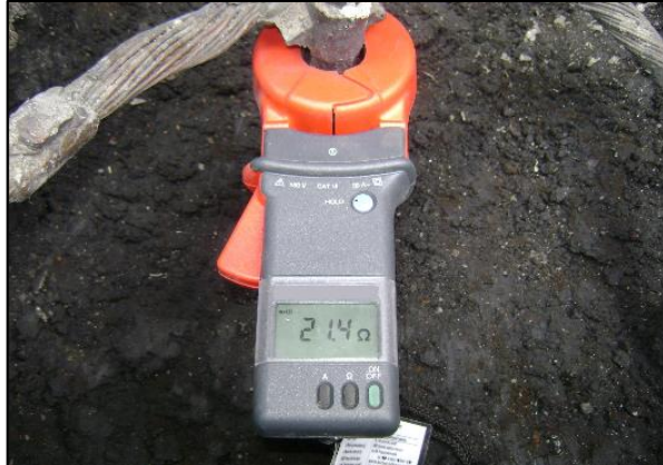
Figura 4.50 Medición de la puesta a tierra mediante un Megger.
