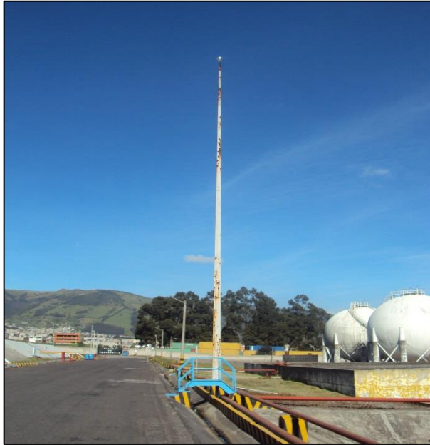
Foto 3.23 Pararrayos con dispositivo de cebado (PDC).
