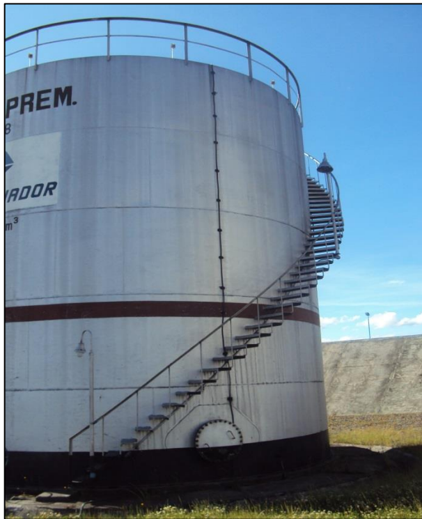
Figura 2.17 Puesta a Tierra para Descarga Atmosférica en Tanque de Almacenamiento de Diesel Premium.
