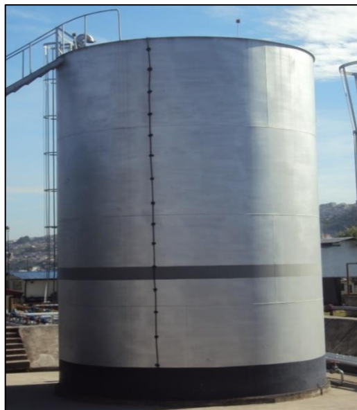
Figura 4.45 Conductor a puesta a tierra en tanque de Mezclas 509.
