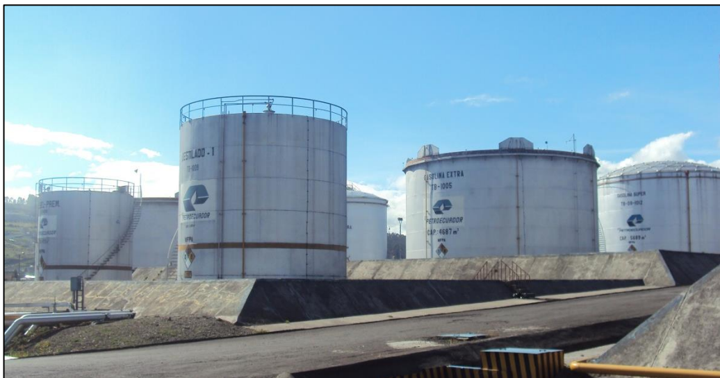
Figura 2.14 Patio de Tanques de Almacenamiento de Combustible.
