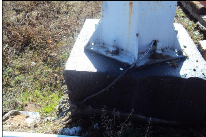
Figura 2.10 Conexión de Puesta Tierra.
