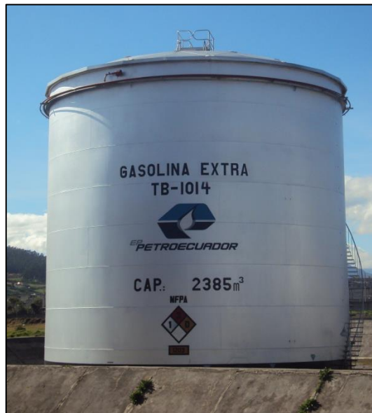
Figura 2.1 Tanque de Almacenamiento TB-1014 de Gasolina Extra.
